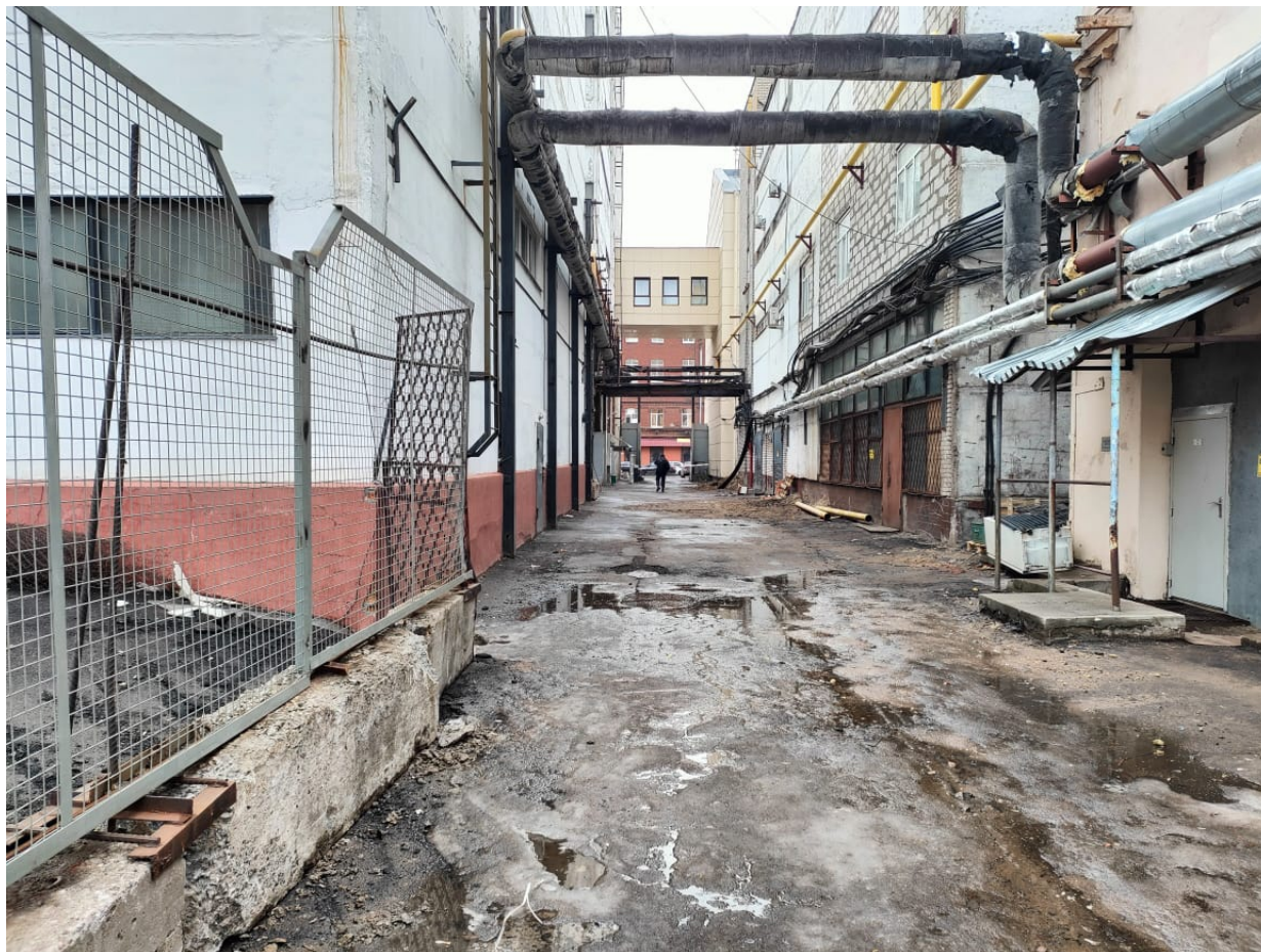
Точка фотофиксации 5. Южная часть участка обследования, внутренний проезд между корпусами. Вид с З.
