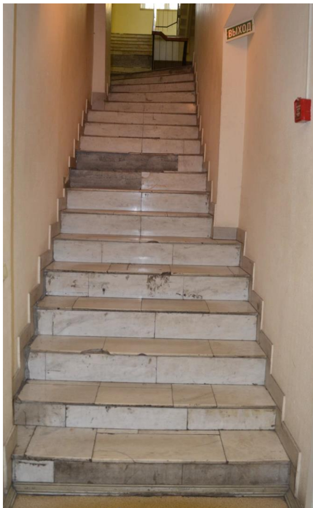
108. Объект культурного наследия регионального значения «Особняк Т.П. Митусова (Э.Ф. Юнкера)» по адресу: г. Санкт-Петербург, Большая Морская ул., д. 59, лит. А. Вид на лестницу Л-7.
