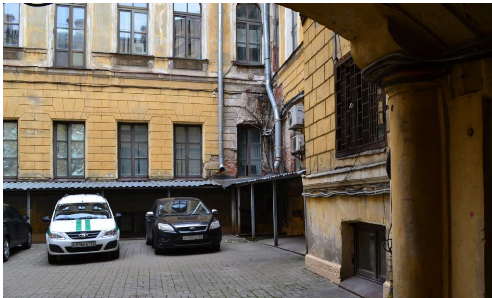
7. Объект культурного наследия регионального значения «Особняк Т.П. Митусова (Э.Ф. Юнкера)» по адресу: г. Санкт-Петербург, Большая Морская ул., д. 59, лит. А. Внутренний двор. Общий вид.
