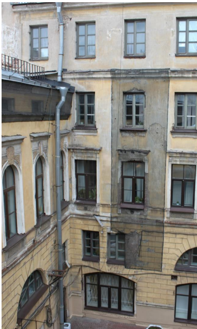
11. Объект культурного наследия регионального значения «Особняк Т.П. Митусова (Э.Ф. Юнкера)» по адресу: г. Санкт-Петербург, Большая Морская ул., д. 59, лит. А. Дворовые фасады. Вид на северный дворовый фасад.
