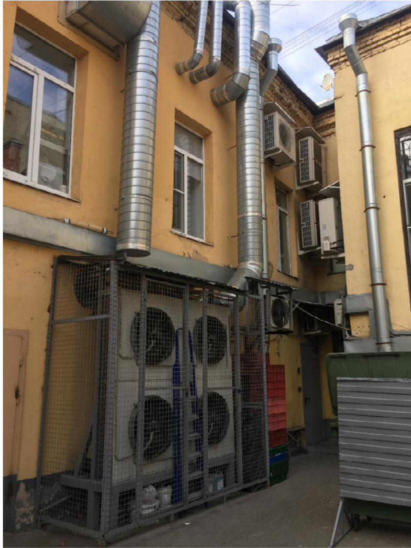
Фото №15. Юго-восточный дворовый фасад, инженерное оборудование.
