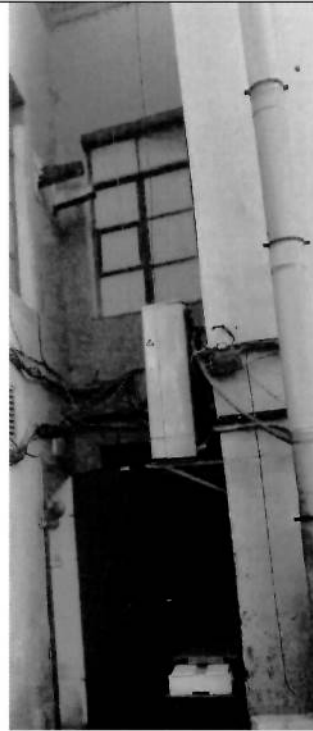
Дверной и оконный проемы со стороны двора и помещения 12-Н. Съёмка 21.03.2012. Л.С. Гуменюк.
