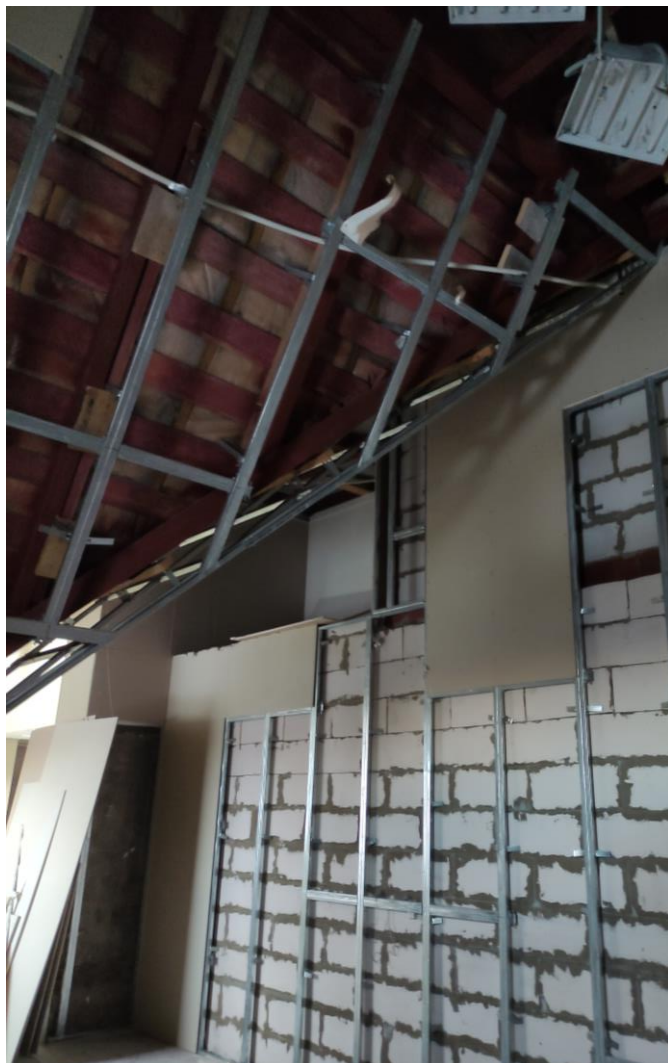
19. Объект культурного наследия регионального значения «Особняк и доходный дом И.Е. Ритинга» по адресу: г. Санкт-Петербург, пр. Добролюбова, д. 1/79, лит. Б. Пятый этаж (мансарда). Квартира №58. Фрагмент интерьера (в зоне восстановления утраченной лестничной клетки в исторических границах).
