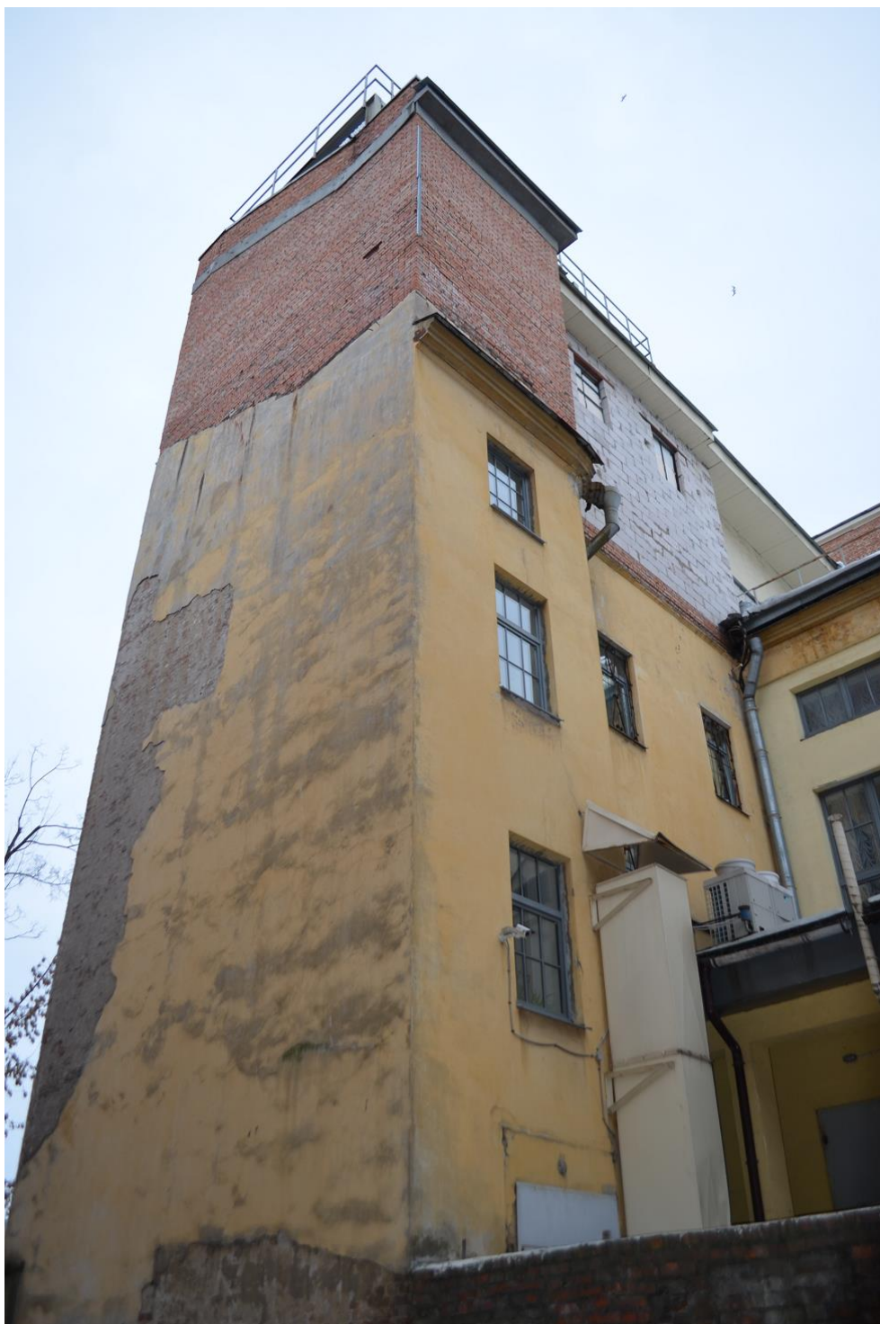
Фото 11. ОКН регионального значения «Городской училищный дом в память 19 февраля 1861 года» (22-я линия В.О., дом 7, литера А). Северо-западный дворовый фасад. Фрагмент. Съёмка 10.02.2022 г.
