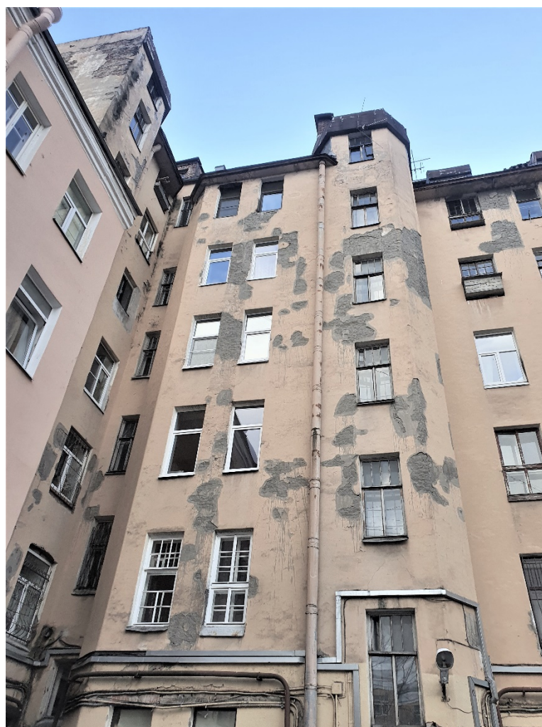
9. Выявленный объект культурного наследия «Дом А.В. Барсовой», по адресу: г. Санкт-Петербург, Заячий пер., д. 6/18, лит. А (Дегтярный пер., 18; Заячий пер., 6). Фрагмент дворового фасада. Дата съемки: 01.03.2022г.
