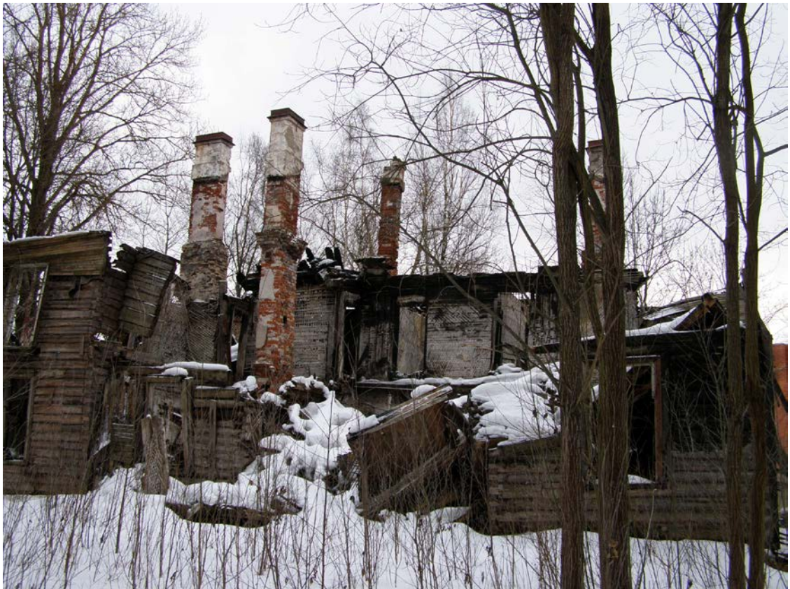
23. Объект культурного наследия регионального значения «Усадьба Ю.И. Жерар-де-Суконтон (главный дом с территорией)», (Санкт-Петербург, г. Петергоф, Собственный пр., д. 4, литера А.). Главный дом, северный фасад.
