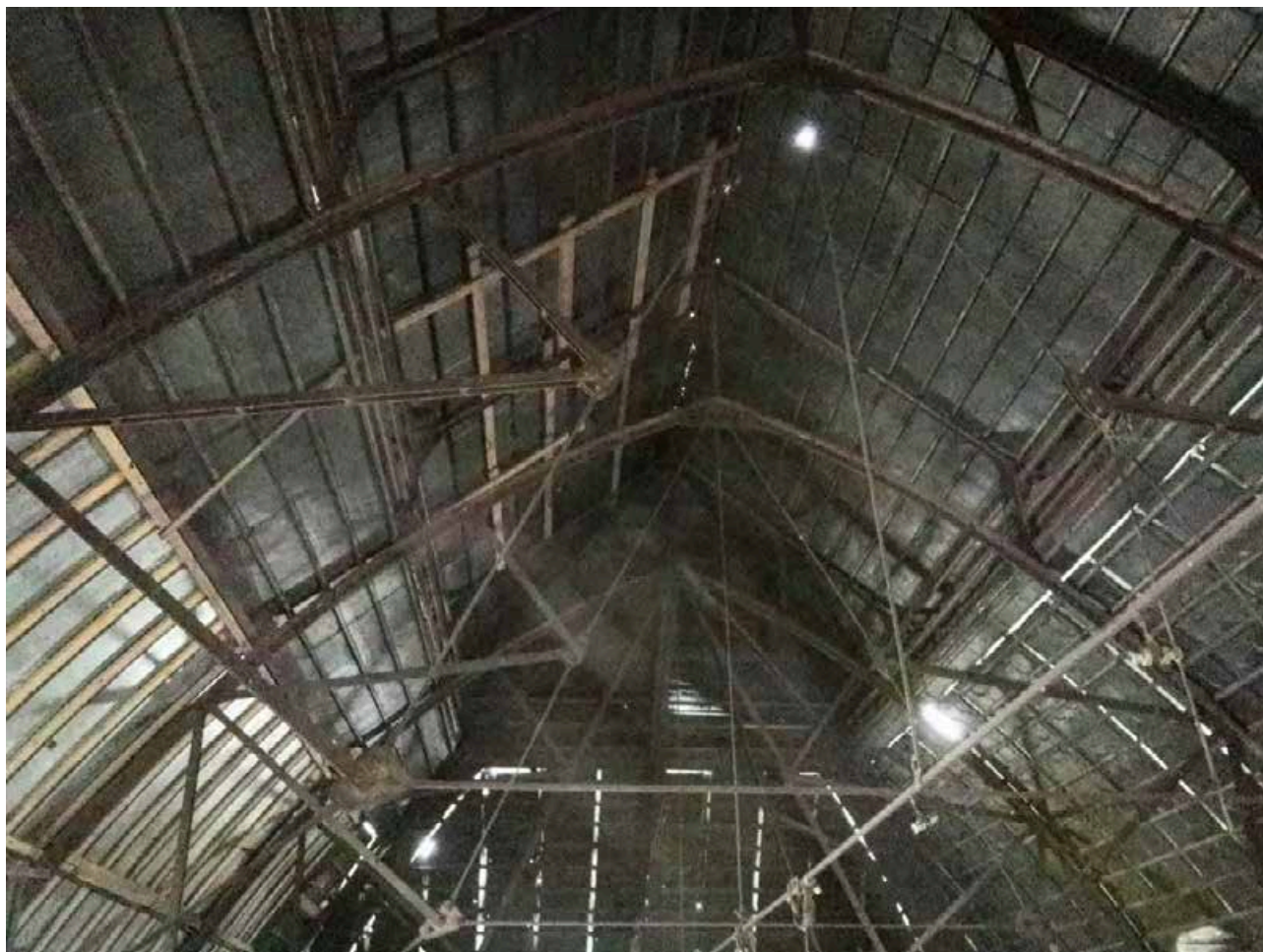
Фото 20. Объект культурного наследия федерального значения "Центральное училище технического рисования и музей Штиглица А.Л" по адресу: Санкт-Петербург, Соляной пер., д. 13-15, лит. А. Кровля и медный купол здания Музея
