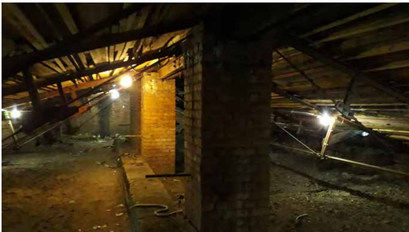
Фото 4. Объект культурного наследия федерального значения "Центральное училище технического рисования и музей Штиглица А.Л" по адресу: Санкт-Петербург, Соляной пер., д. 13-15, лит. А. Кровля и медный купол здания Музея
