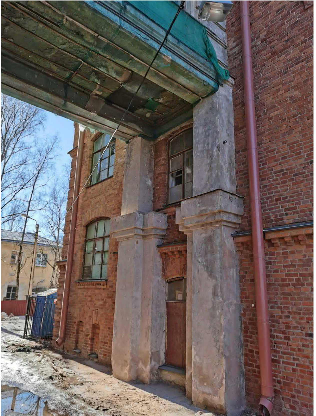
Фото 13. Здание по адресу по ул. Юты Бондаровской д.13, к.1. Примыкание к зданию ОКН по адресу по ул. Юты Бондаровской д.21
