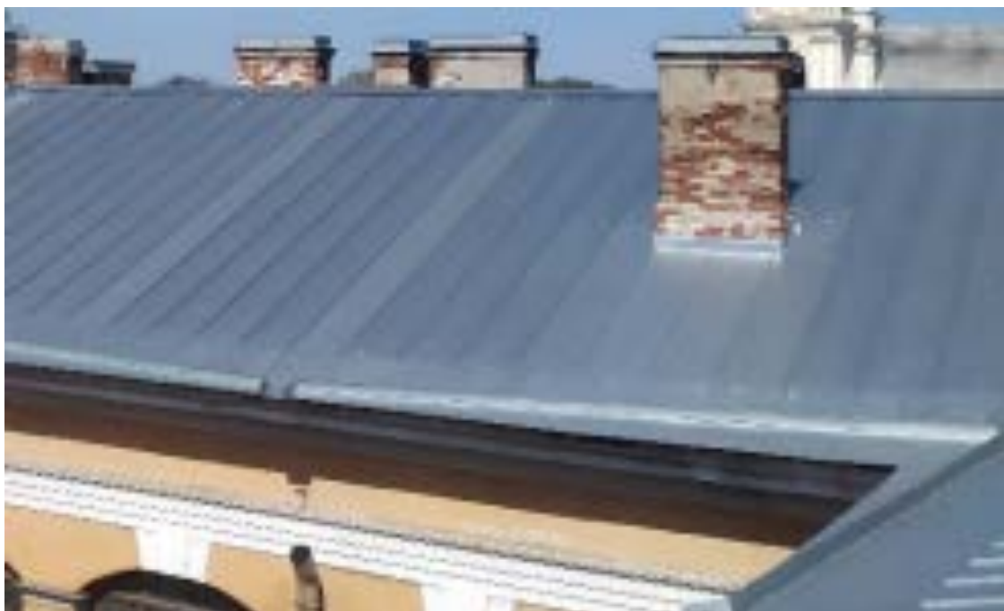
27. Северная часть крыши объекта культурного наследия регионального значения «Главное здание», расположенного по адресу: г. Санкт-Петербург, наб. Обводного канала, д. 7, лит. Г, входящего в состав объекта культурного наследия регионального значения «Духовная академия». 23.11.2020.
