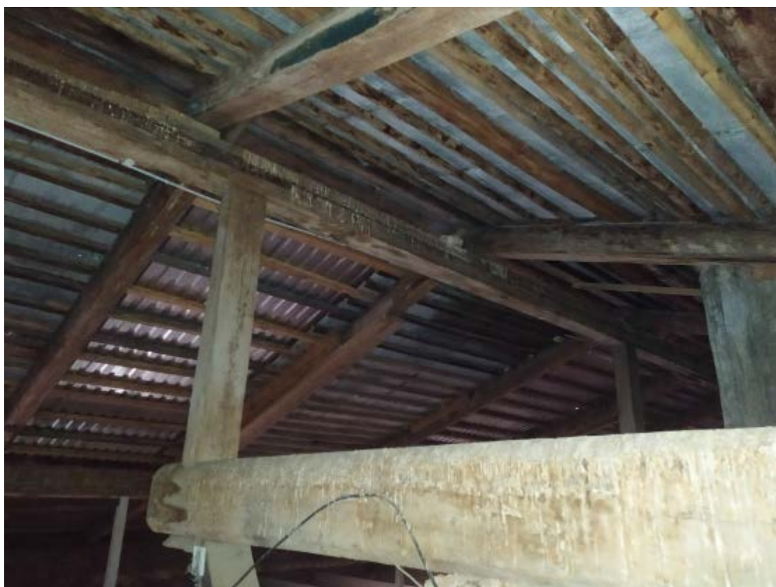
16. Стропильная система крыши объекта культурного наследия регионального значения «Главное здание», расположенного по адресу: г. Санкт-Петербург, наб. Обводного канала, д. 7, лит. Г, входящего в состав объекта культурного наследия регионального значения «Духовная академия». 23.11.2020.
