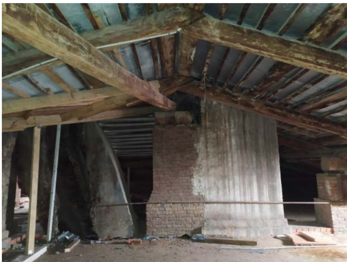
18. Стропильная система крыши объекта культурного наследия регионального значения «Главное здание», расположенного по адресу: г. Санкт-Петербург, наб. Обводного канала, д. 7, лит. Г, входящего в состав объекта культурного наследия регионального значения «Духовная академия». 23.11.2020.
