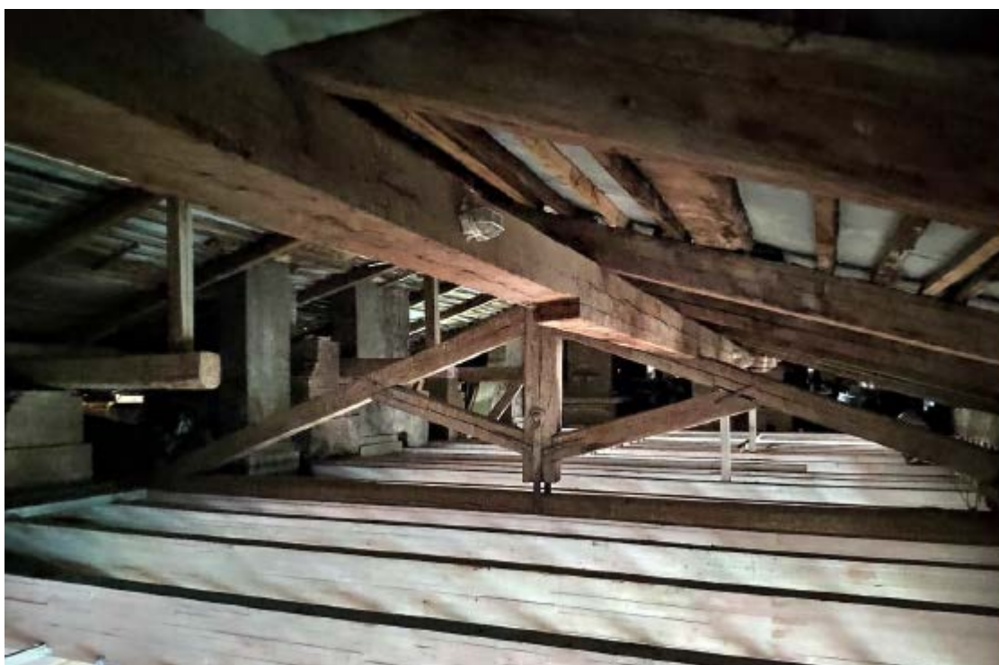
15. Стропильная система крыши объекта культурного наследия регионального значения «Главное здание», расположенного по адресу: г. Санкт-Петербург, наб. Обводного канала, д. 7, лит. Г, входящего в состав объекта культурного наследия регионального значения «Духовная академия». 23.11.2020.
