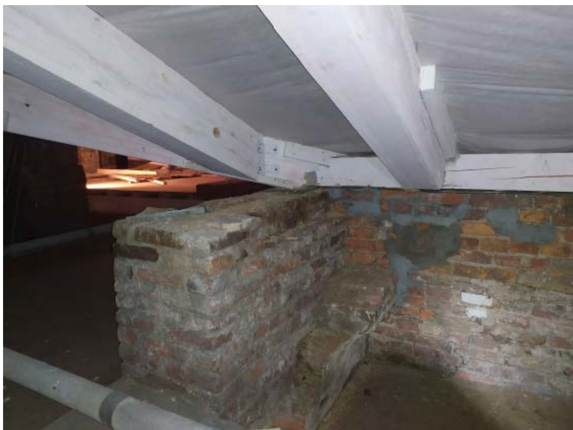
22. Стропильная система крыши объекта культурного наследия регионального значения «Главное здание», расположенного по адресу: г. Санкт-Петербург, наб. Обводного канала, д. 7, лит. Г, входящего в состав объекта культурного наследия регионального значения «Духовная академия». 23.11.2020.
