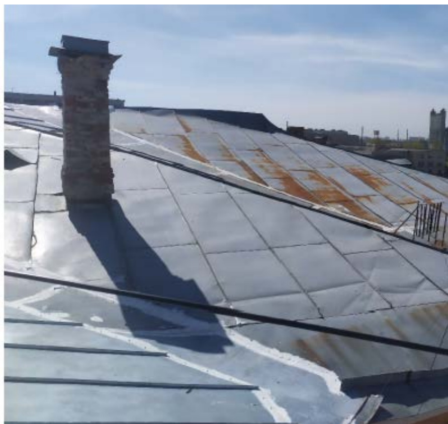
29. Кровля в осях 1-12/А-Н объекта культурного наследия регионального значения «Главное здание», расположенного по адресу: г. Санкт-Петербург, наб. Обводного канала, д. 7, лит. Г, входящего в состав объекта культурного наследия регионального значения «Духовная академия». 23.11.2020.
