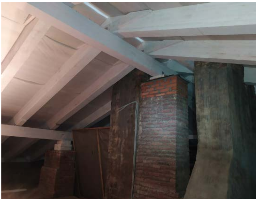
21. Стропильная система крыши объекта культурного наследия регионального значения «Главное здание», расположенного по адресу: г. Санкт-Петербург, наб. Обводного канала, д. 7, лит. Г, входящего в состав объекта культурного наследия регионального значения «Духовная академия». 23.11.2020.
