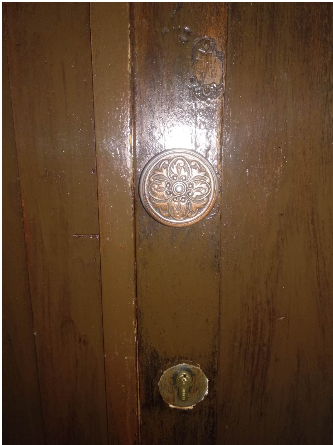
Фото 33. Фрагмент дверного заполнения ДВ-3 со стороны помещения №56. Потертости, механические повреждения древесины
