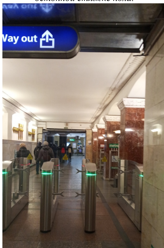
Фото 14. Объект культурного наследия регионального значения «Станция метро «Автово» (с перронным залом)». Вестибюль подземного этажа (коридор, ведущий из аванзала в нижний кассовый зал). Место проектируемого канала инженерных сетей в бетонной стяжке пола.
