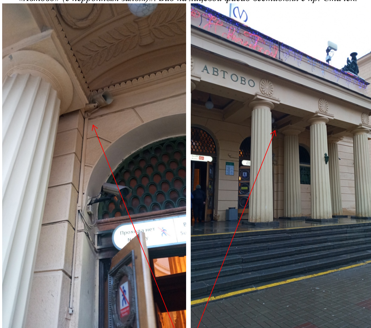
Фото 2. Объект культурного наследия регионального значения «Станция метро «Автово» (с перронным залом)». Вид на лицевой фасад вестибюля с пр. Стачек. Громкоговорители существующей системы оповещения.
