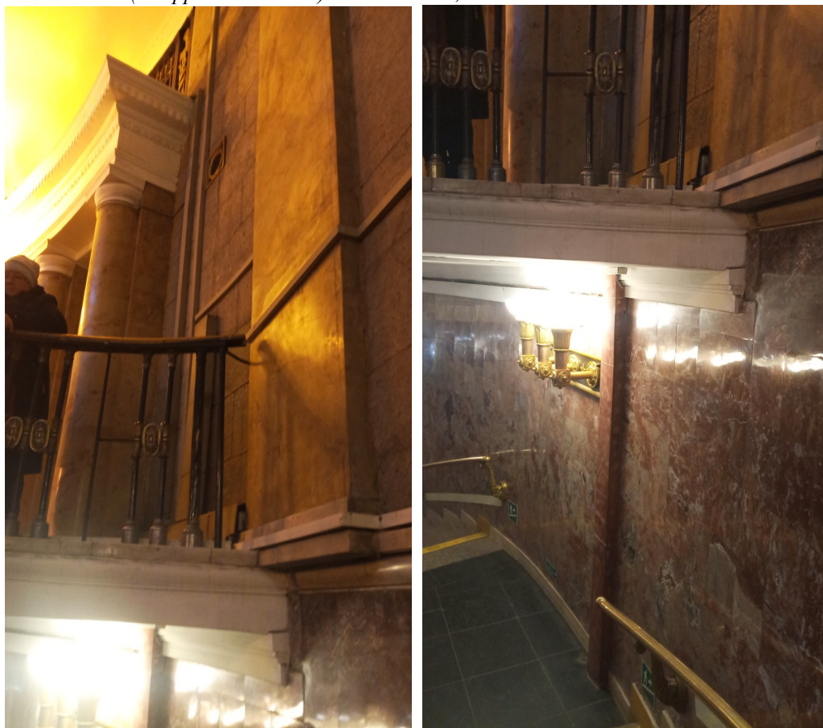
Фото 8. Объект культурного наследия регионального значения «Станция метро «Автово» (с перронным залом)». Вестибюль, 1 этаж. Вид части кассового зала с лестницы. По стенам наружно проложены существующие инженерные сети в коробах.
