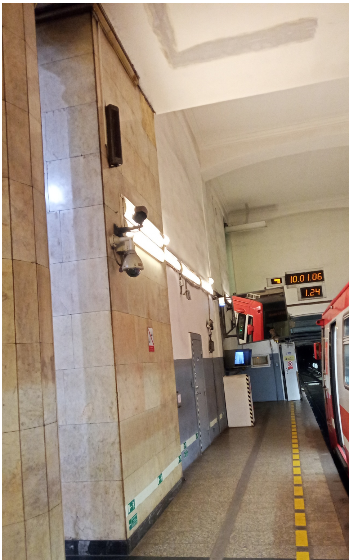
Фото 21. Объект культурного наследия регионального значения «Станция метро «Автово» (с перронным залом)». Перронный зал. Существующие инженерные сети проложены вдоль стен наружно, в коробах.
