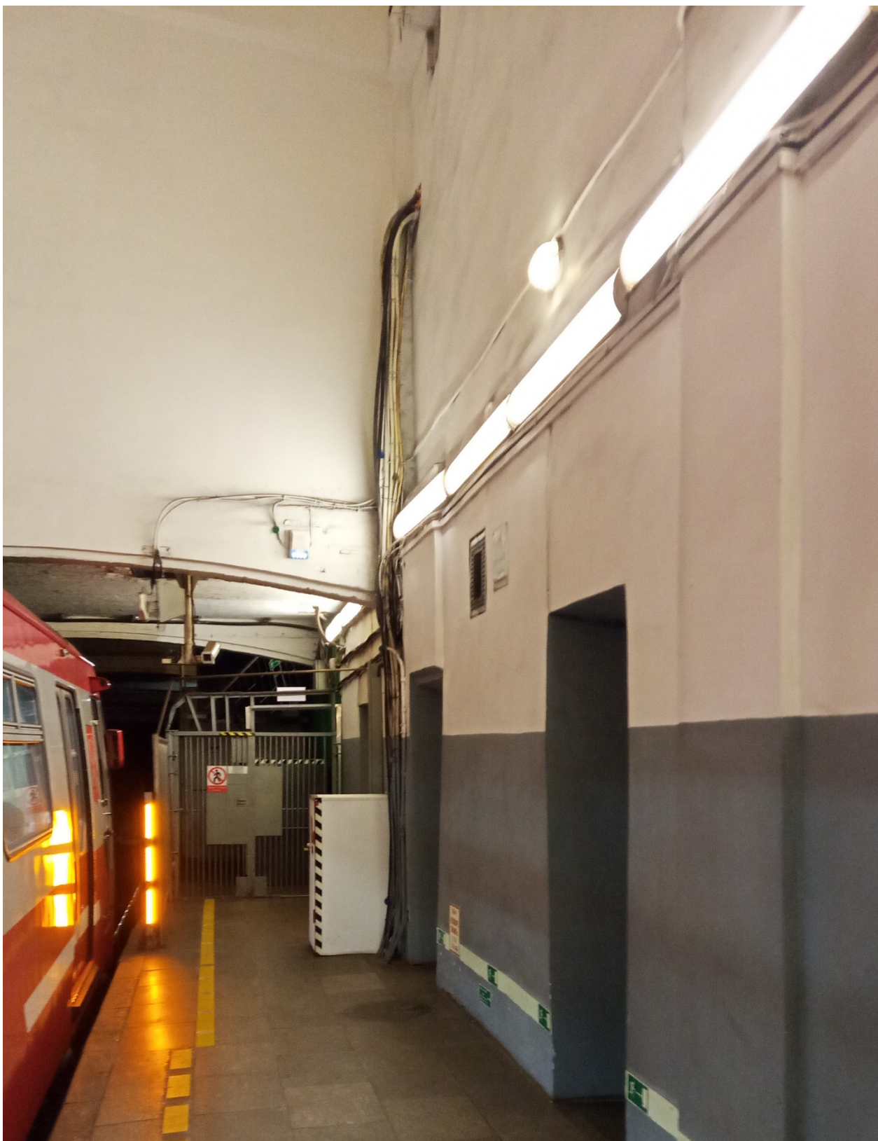
Фото 20. Объект культурного наследия регионального значения «Станция метро «Автово» (с перронным залом)». Перронный зал. Существующие инженерные сети проложены вдоль стен наружно, в коробах.
