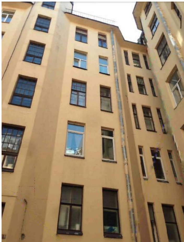
7. Дом Р.А. Дидерихса (Большой пр. П.С., д. 104, лит. А). Фото места предполагаемого размещения кабельной трассы на дворовом фасаде. Штиглиц М.С. 01.09.2020.
