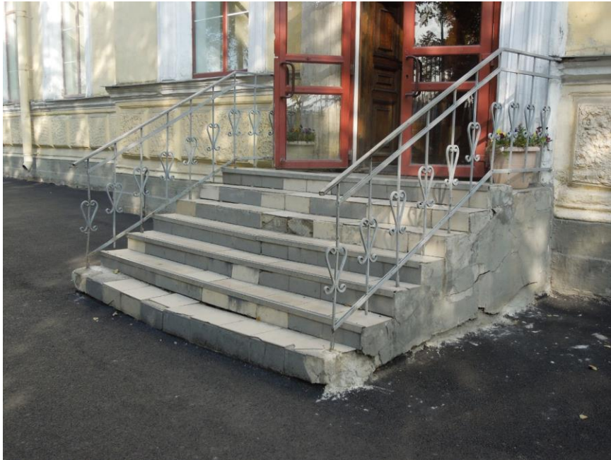
73. Выявленный объект культурного наследия «Лабораторный корпус», входящий в состав выявленного объекта культурного наследия «Комплекс зданий Михайловского военного училища и академии». Главный фасад. Лестница главного входа в здание с современным металлическим ограждением.
