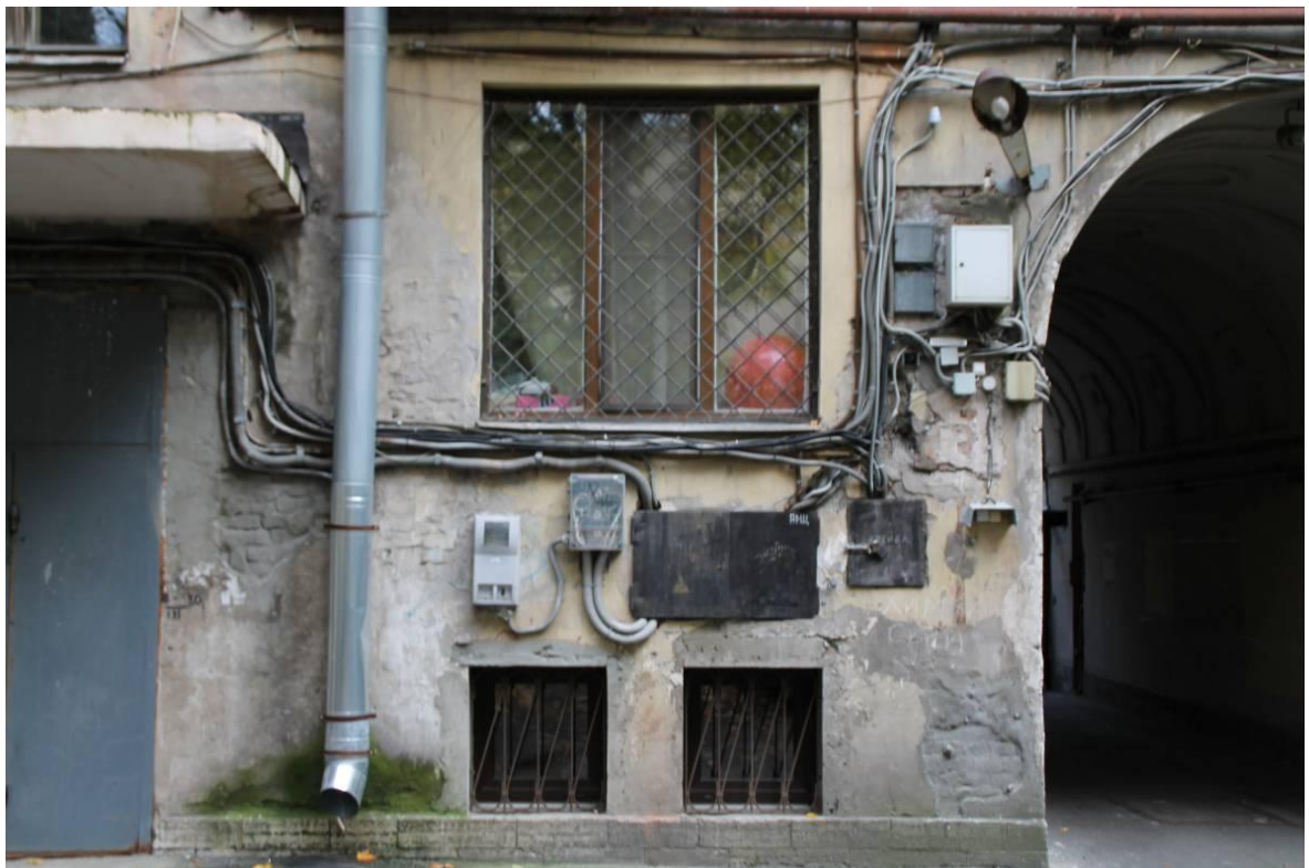
Рис. 8 Увлажнение, биопоражение и механические повреждения цоколя. Общее увлажнение, загрязнение, проявление сетки усадочных волосяных трещин на поверхности фасада, следы кустарного ремонта стены. Деструкция и биопоражение штукатурного слоя стены, оголение кладки.
