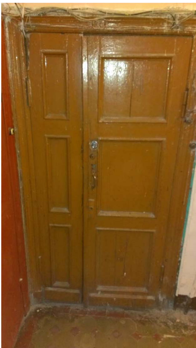
Фото 5. Дверной проем квартиры № 34.
