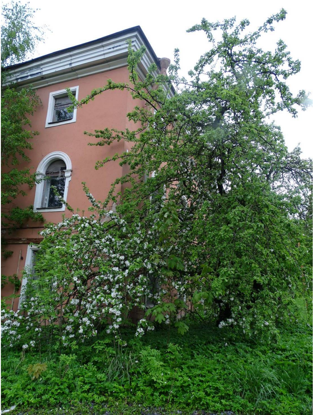
Фото 11. Здание по адресу: наб. реки Малой Невки, дом 13, литера А. Южная часть территории. Съемка Трушковский В.Э.21.05.2021 г.
