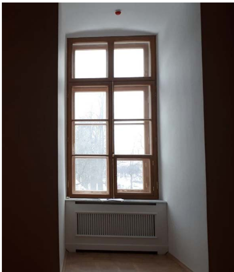
10. Объект культурного наследия федерального значения «Замок», входящий в состав объекта культурного наследия федерального значения «Михайловский (Инженерный) замок», по адресу: г. Санкт-Петербург, Центральный район, ул. Садовая, д. 2, лит. А (Садовая ул., 2). Первый этаж. Помещение 136. Фрагмент интерьера.
