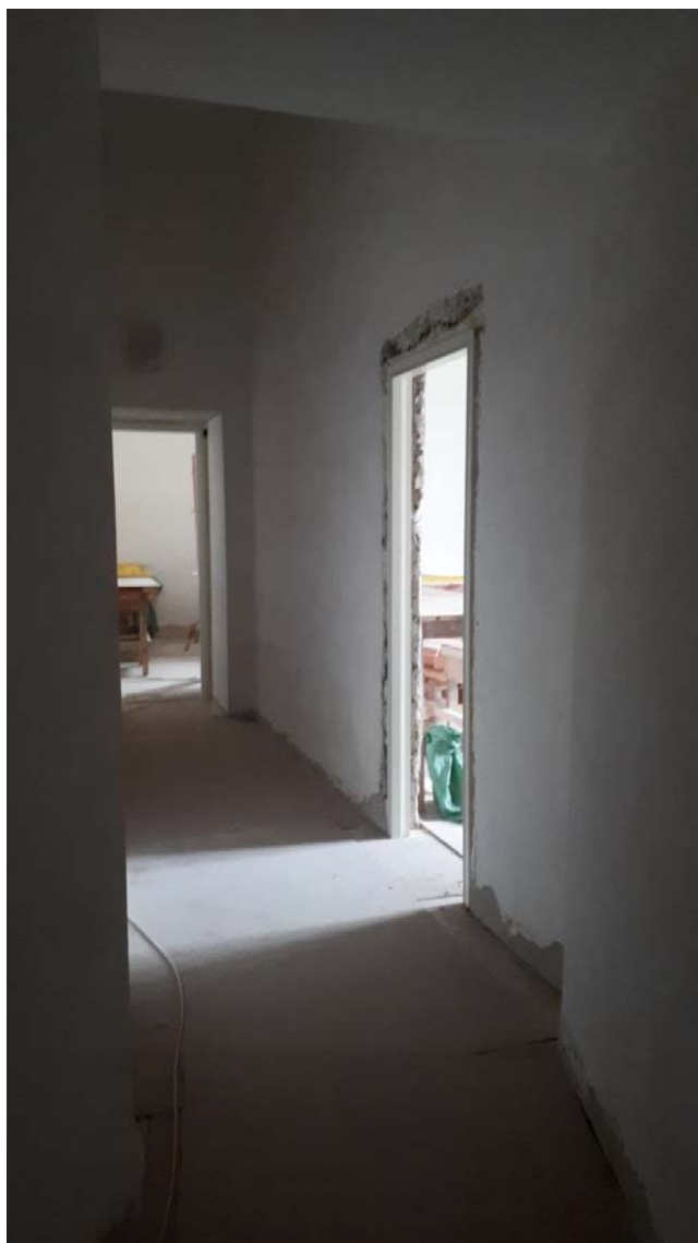
13. Объект культурного наследия федерального значения «Замок», входящий в состав объекта культурного наследия федерального значения «Михайловский (Инженерный) замок», по адресу: г. Санкт-Петербург, Центральный район, ул. Садовая, д. 2, лит. А (Садовая ул., 2). Первый этаж. Помещения 144, 146. Фрагмент интерьера.
