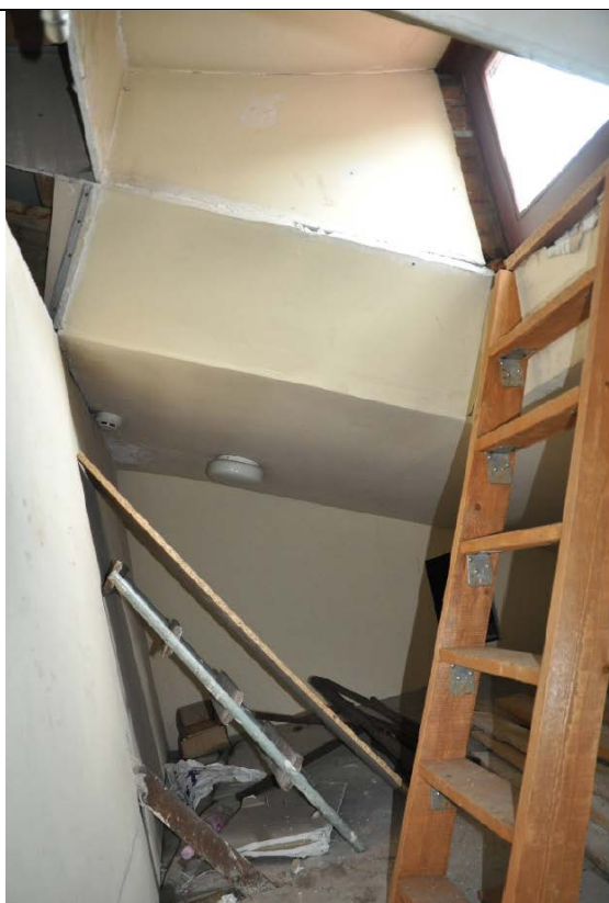
Фото 80. Помещение №23 в осях 2-3. Подкровельное пространство. (23.09.2020 г.)
