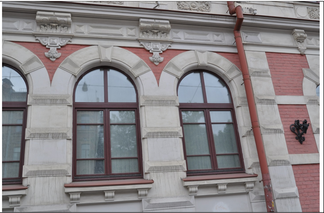
Фото 3. Фрагмент Юго-Восточного фасада на уровне первого этажа в осях 6-1 по улице Марата (23.09.2020 г.)
