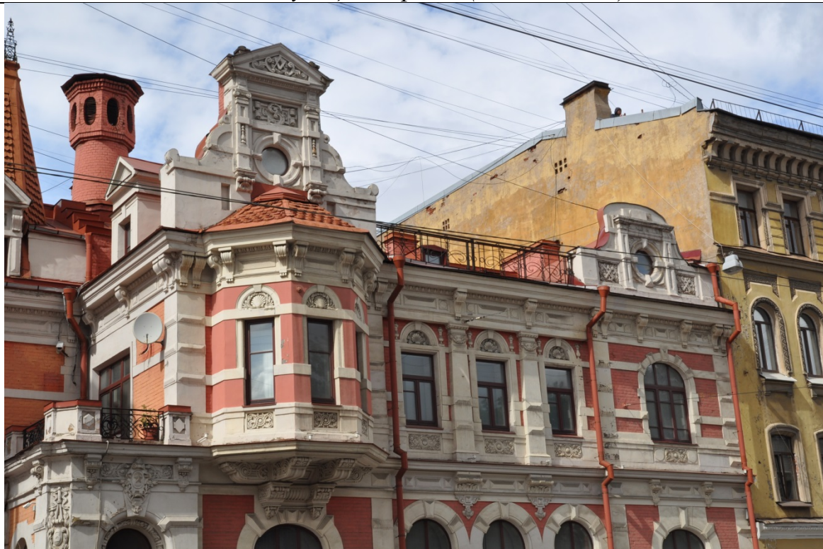
Фото 2. Фрагмент Юго-Восточного фасада на уровне второго этажа в осях 6-1 по улице Марата. (23.09.2020 г.)
