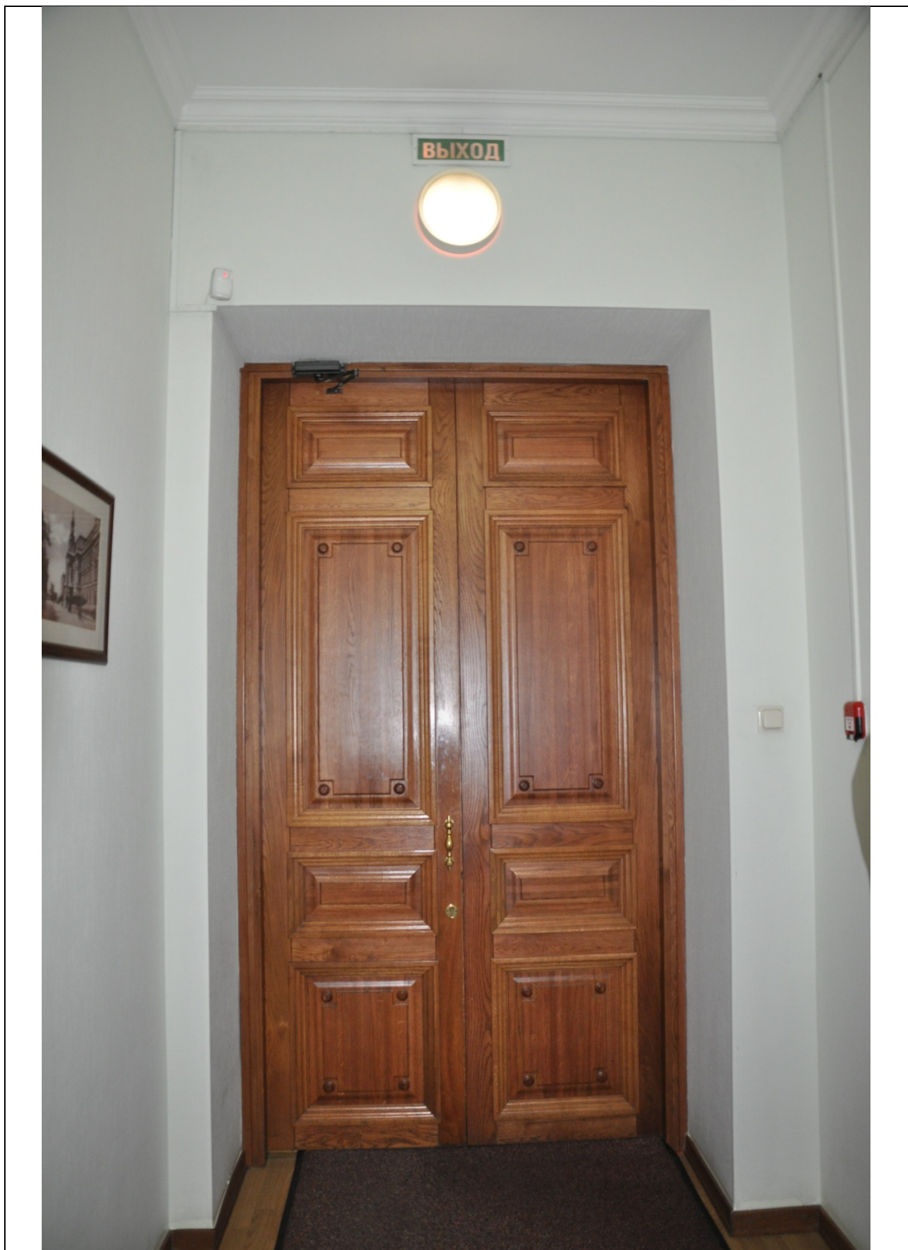
Фото 65. Коридор в осях 2-4. Входная дверь в коридор 2 этажа. Столярное двустворчатое филенчатое заполнение(23.09.2020 г.)
