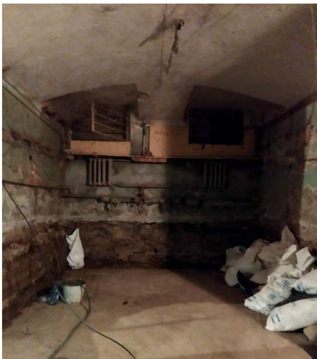
12. Корпус по Замятину переулку. Подвал. Пом. 3-Н (1). Дата съёмки: 20 апреля 2021 г. Фотограф: Тимошенков Д.В.
