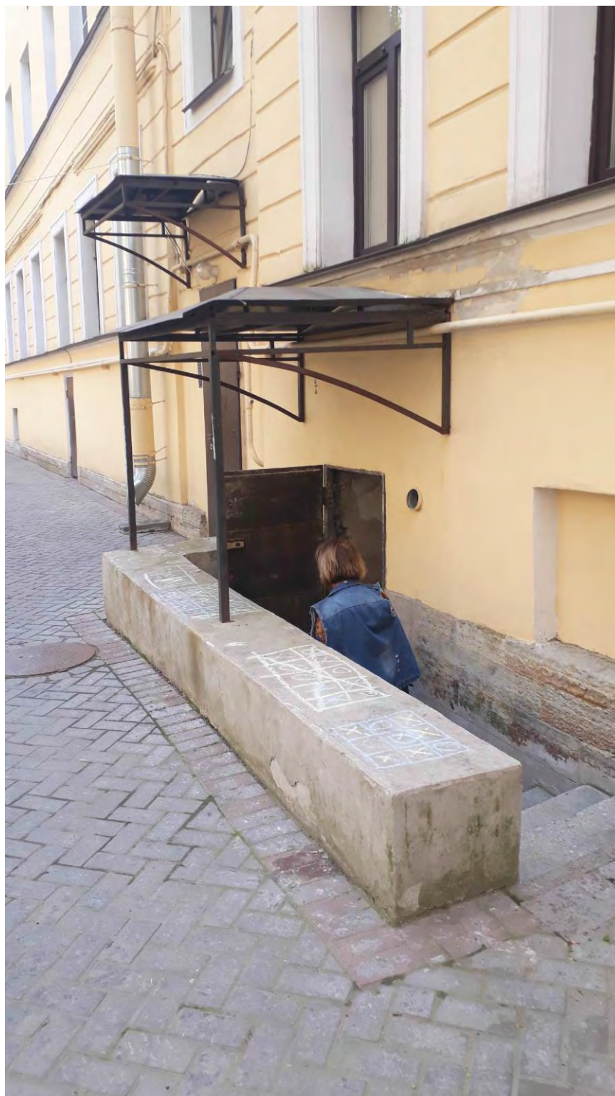
6. Фрагмент дворового фасада объекта культурного наследия «Дом В.П. Орлова-Давыдова». Корпус по Замятину пер, вход в подвальное помещение 3-Н. Дата съемки: 20 апреля 2021 г. Фотограф: Тимошенко Д.В.
