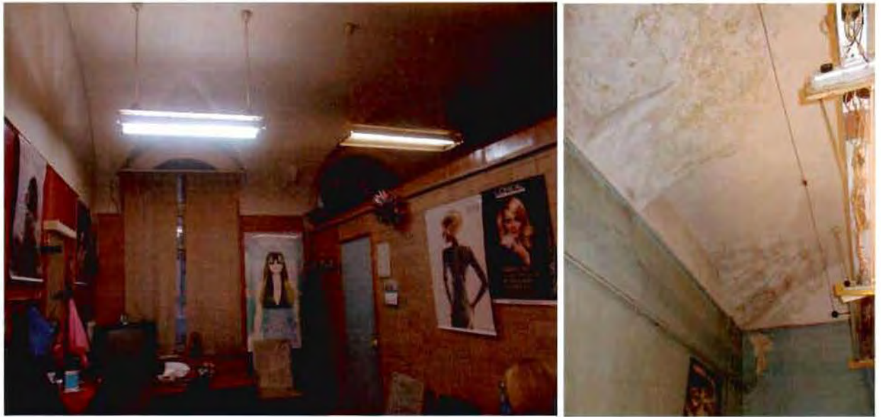
40, 41. Интерьеры и техническое состояние пом. 8-Н (вход со стороны арки)
