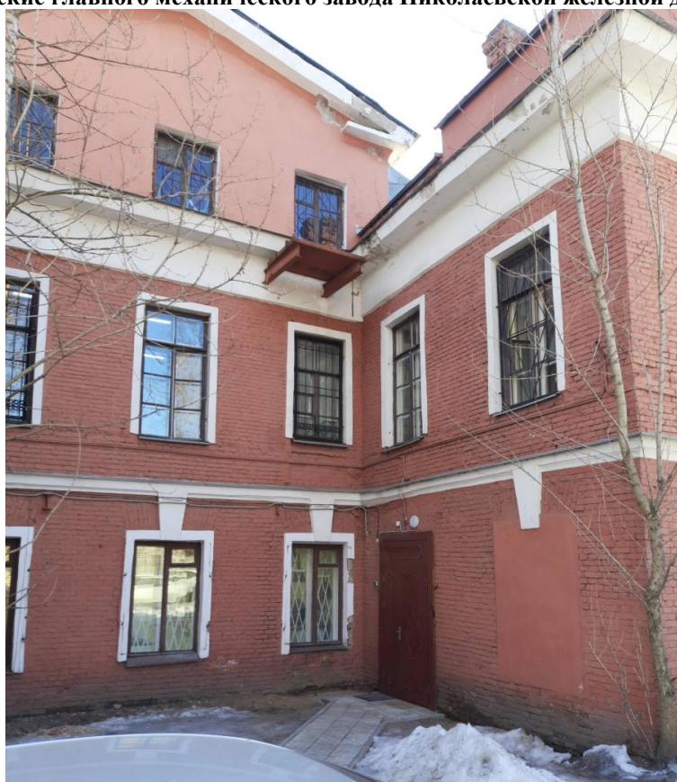
Фото 4 Фрагмент лицевого фасада выявленного объекта культурного наследия «Здание Главной конторы» в составе ансамбля «Комплекс построек Александровского чугунолитейного завода (паровозные мастерские главного механического завода Николаевской железной дороги)»
