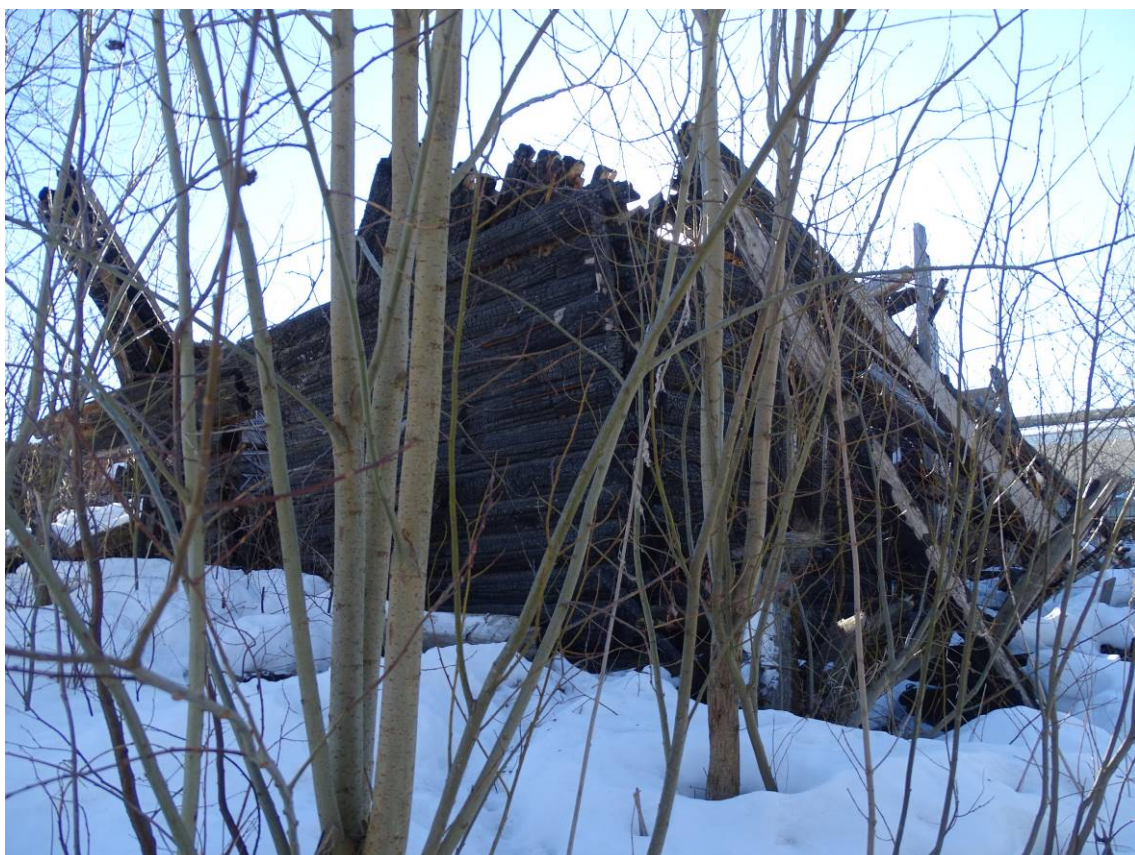
Илл. 08. Объект культурного наследия регионального значения "Жилой дом" по адресу: Санкт-Петербург, г. Ломоносов, ул. Рубакина, д. 11, лит. А. Северо-западная часть здания. Съемка 01.03.2022 г. Трушковский В. Э.
