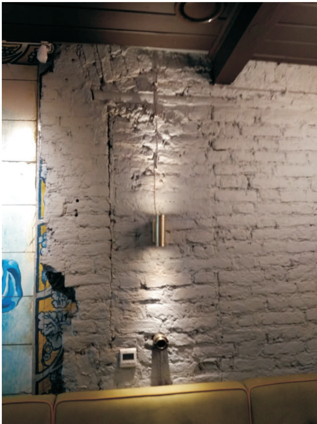
Ил. 79. Дом №20 по набережной реки Фонтанки. Помещение 1-Н. Фрагмент южной стены второго этажа с заложенными разновременными проемами с лучковой и прямой перемычками. Фотография 10.06.2021 г.
