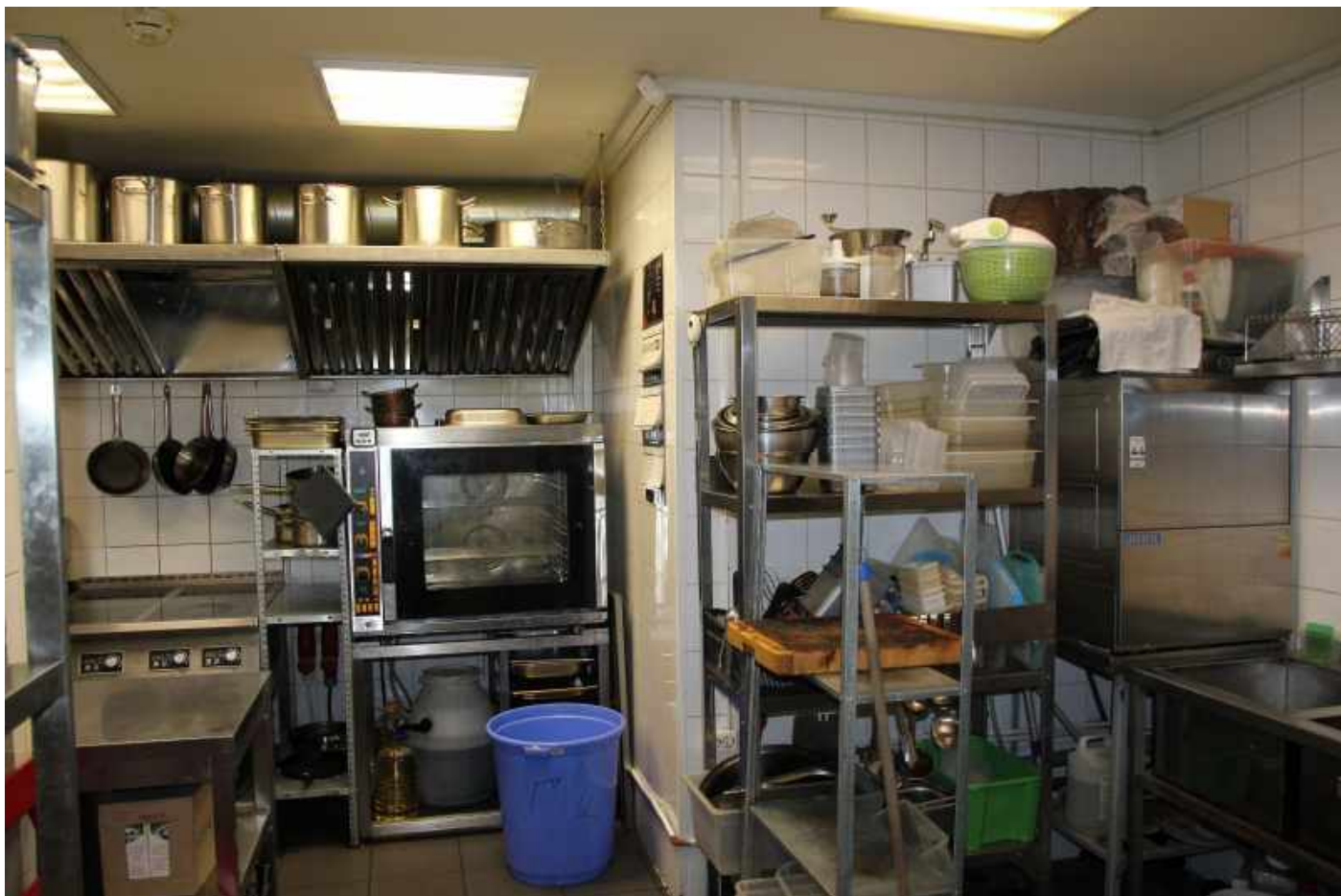
Фото№20: Вид на оборудование кухни
