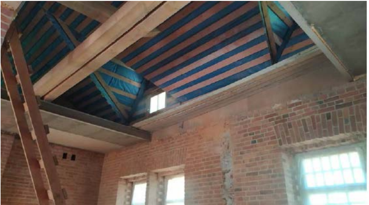
10. Помещение №1 (2-Н и 3-Н) объекта культурного наследия регионального значения «Службы при дворце О.В. Гогенфельзен (Палей)», расположенного по адресу: Санкт-Петербург, г. Пушкин, Московский пер. д. 7/20, литера А. Проем в чердачном перекрытии. 30.01.2022.
