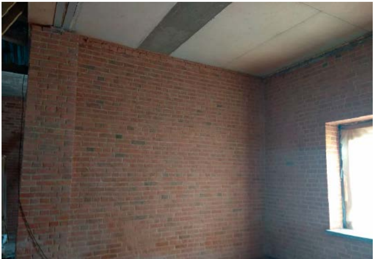
11. Помещение №1 (4-Н и 5-Н) объекта культурного наследия регионального значения «Службы при дворце О.В. Гогенфельзен (Палей)», расположенного по адресу: Санкт-Петербург, г. Пушкин, Московский пер. д. 7/20, литера А. Проем в чердачном перекрытии. 30.01.2022.
