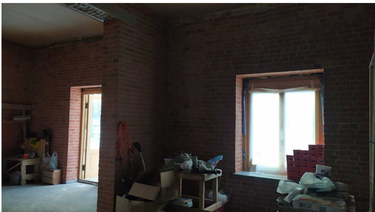
5. Помещение №1 (5-Н) в уровне 1-го этажа объекта культурного наследия регионального значения «Службы при дворце О.В. Гогенфельзен (Палей)», расположенного по адресу: Санкт-Петербург, г. Пушкин, Московский пер. д. 7/20, литера А. 30.01.2022.
