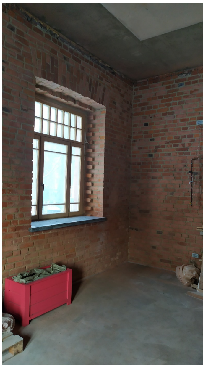
8. Помещение №1 (6-Н) в уровне 1-го этажа объекта культурного наследия регионального значения «Службы при дворце О.В. Гогенфельзен (Палей)», расположенного по адресу: Санкт-Петербург, г. Пушкин, Московский пер. д. 7/20, литера А. 30.01.2022.
