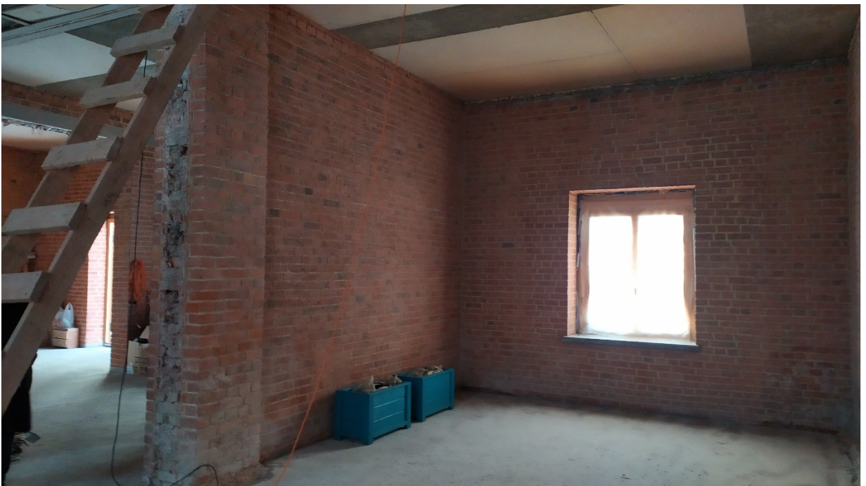
9. Помещение №1 (2-Н и 3-Н) в уровне 1-го этажа объекта культурного наследия регионального значения «Службы при дворце О.В. Гогенфельзен (Палей)», расположенного по адресу: Санкт-Петербург, г. Пушкин, Московский пер. д. 7/20, литера А. 30.01.2022.
