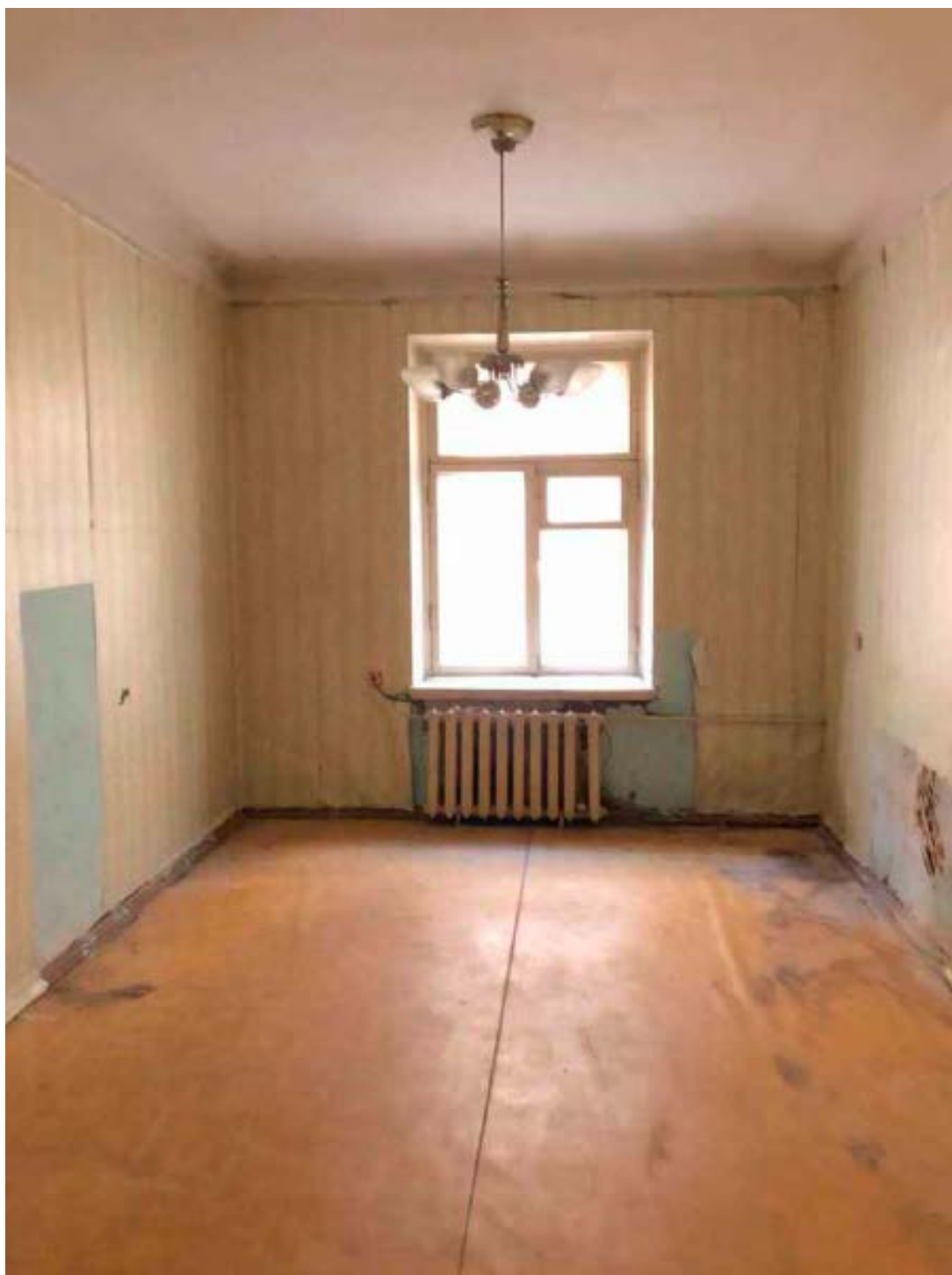
9. Помещение №17 кв. №11 в уровне 1-го этажа объекта культурного наследия регионального значения «Дом кн. Л.Д. Вяземского», расположенного по адресу: г. Санкт-Петербург, Галерная ул., д. 67, литера А. 15.12.2021.
