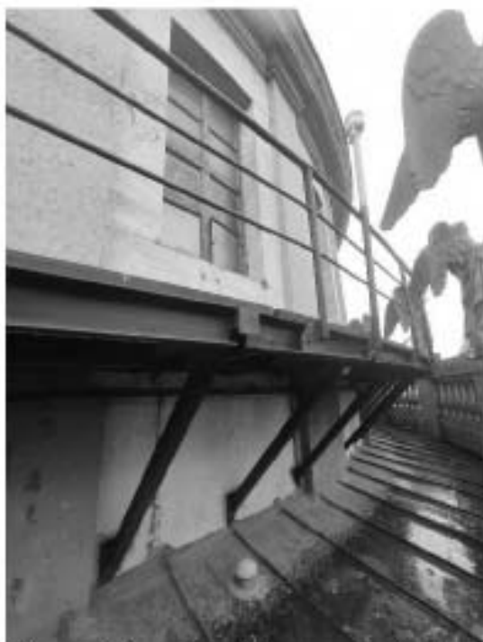
49. «Ансамбль Исаакиевской площади: Музей-памятник Исаакиевский собор», 1818-1858 гг., арх. А.А. Монферран, Исаакиевская площадь, дом 4, литера А. Барабан. Фрагмент. Фото 31.01.2020 г.
