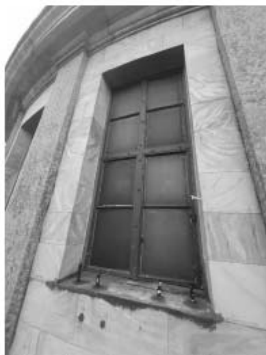
25. «Ансамбль Исаакиевской площади: Музей-памятник Исаакиевский собор», 1818-1858 гг., арх. А.А. Монферран, Исаакиевская площадь, дом 4, литера А. Барабан. Фрагмент. Фото 31.01.2020 г.
