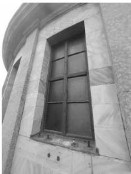
11. «Ансамбль Исаакиевской площади: Музей-памятник Исаакиевский собор», 1818-1858 гг., арх. А.А. Монферран, Исаакиевская площадь, дом 4, литера А. Барабан. Фрагмент. Фото 31.01.2020 г.
