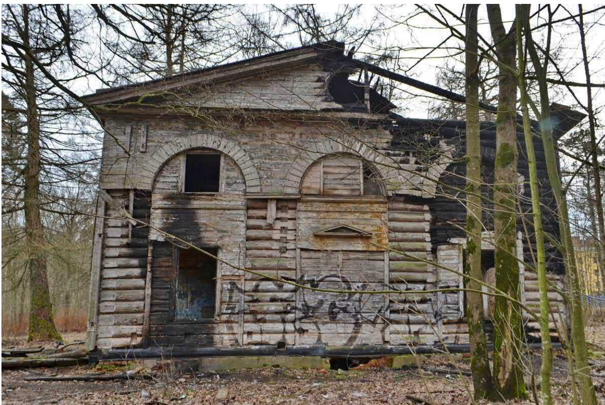
24. Современное состояние Усадьбы Вяземских (после пожара)
