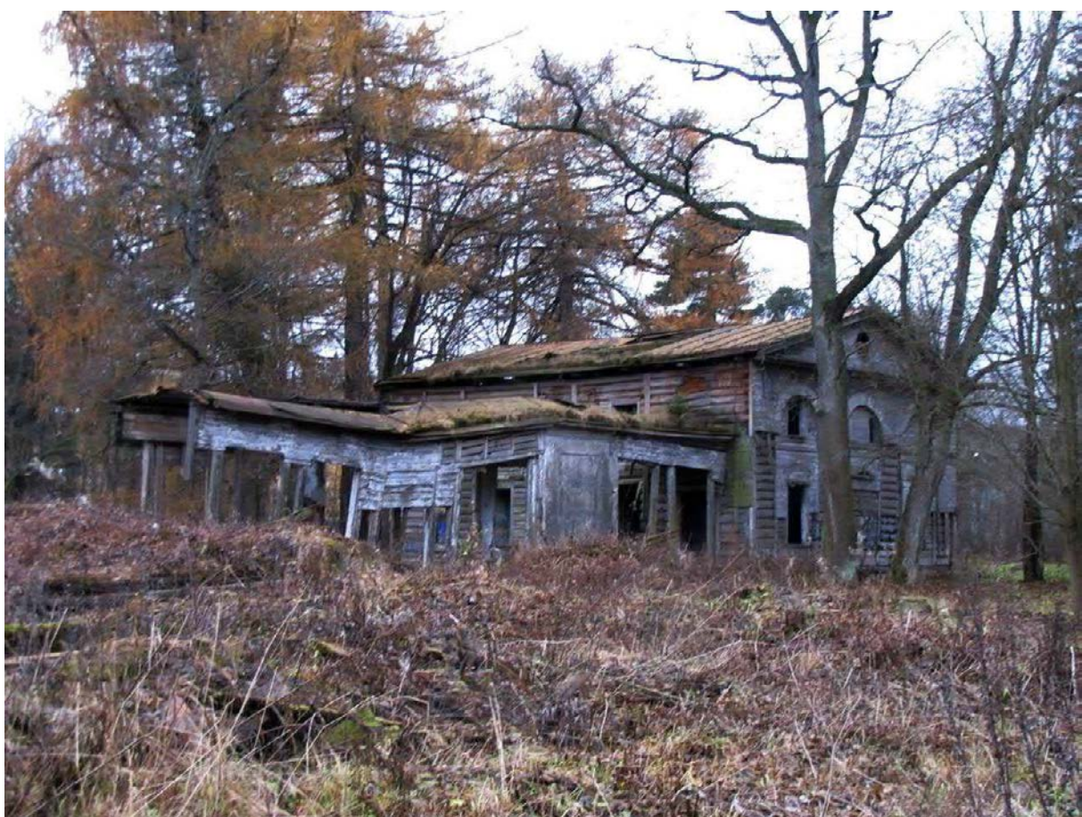
23. Современное состояние Усадьбы Вяземских (после пожара)
