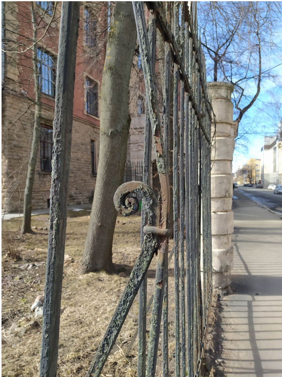
Фрагмент металлической ограды. Крепление контрфорса. Механические повреждения ограды. Дата съёмки 09.04.2022.
