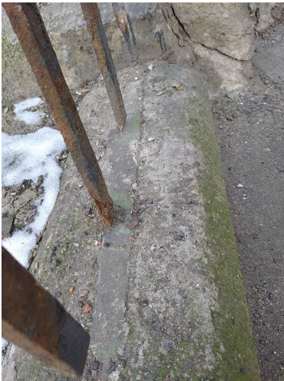
Фрагмент цокольного блока. Стойки ограды с повреждениями от коррозии. Дата съёмки 09.04.2022.
