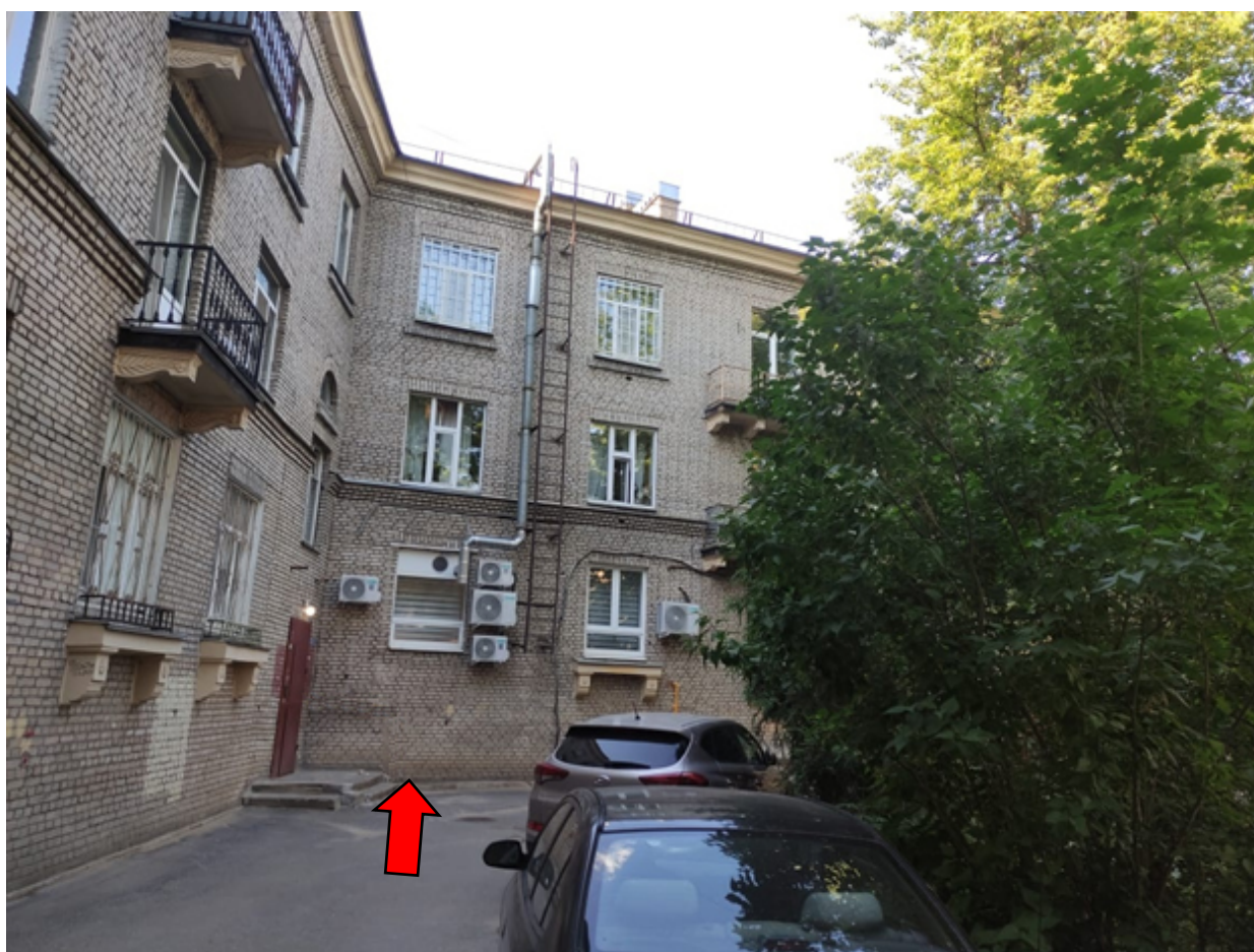
Рис. 1. Вид на Объект (место будущей двери отмечено стрелкой) с дворовой территории. Фото от 01.07.2021 г.
