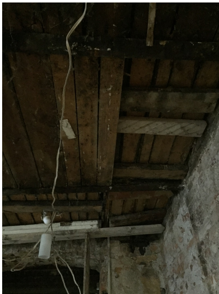
Фото 16. Существующее состояние досок подбора перекрытия в зоне бывшего санузла.
