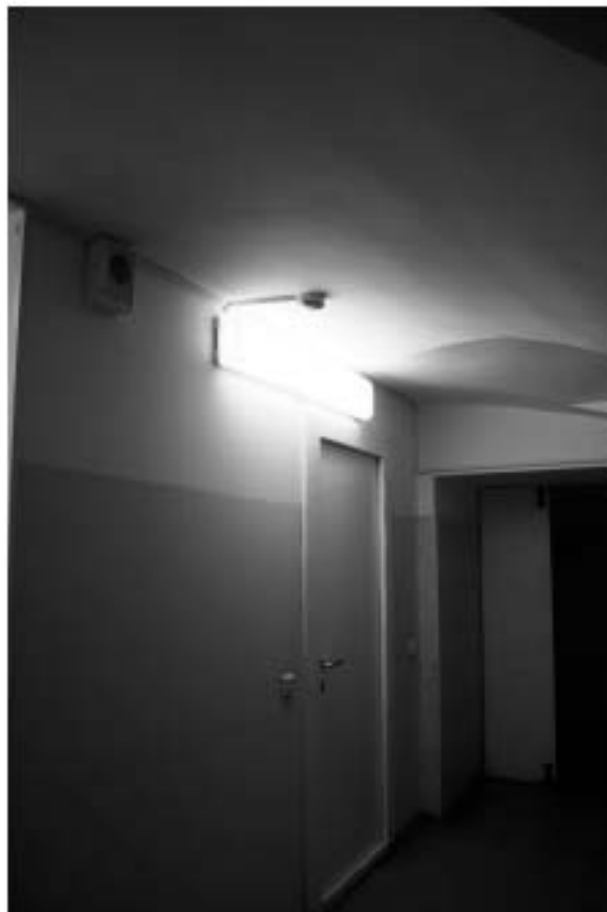
Фото 70. У проема между помещениями 43 и 44. Подвал.
