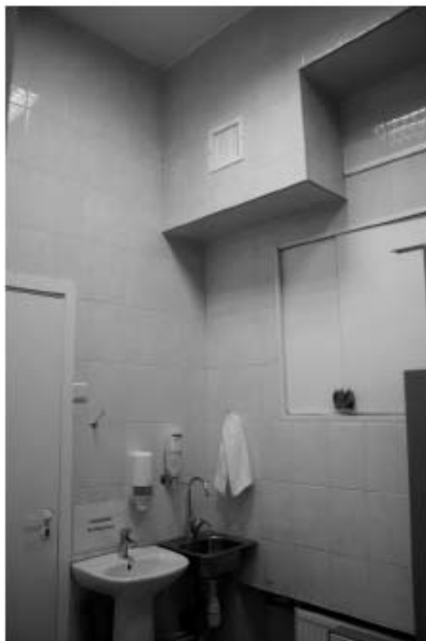
Фото 87. Санузел в кабинете КТ.
