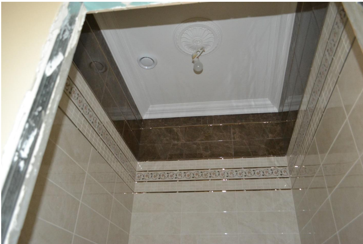
Фото 25. Потолок помещение №14. Туалет.
