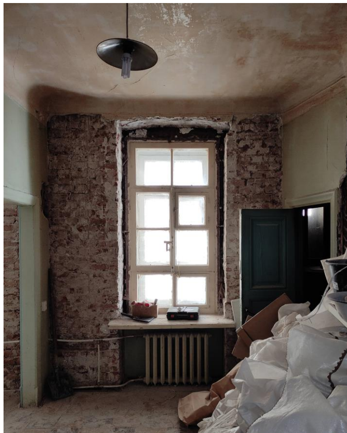
Фото 22. Общий вид пом. № 55(11). Оконный проем во внутренний двор, оконное заполнение с исторической расстекловкой.
