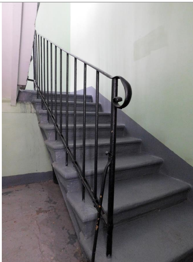
28. Лестница западного входа. Декоративный элемент перил первого марша. Фото М. И. Мильчика, 02.02.2018
