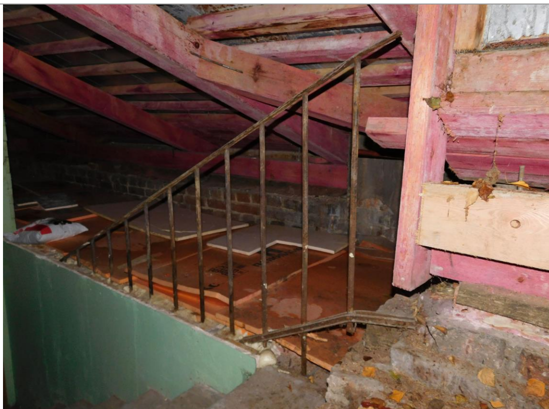
50. Исторические перила последнего марша лестницы западного входа на чердаке. Фото М. И. Мильчика, 02.02.2018
