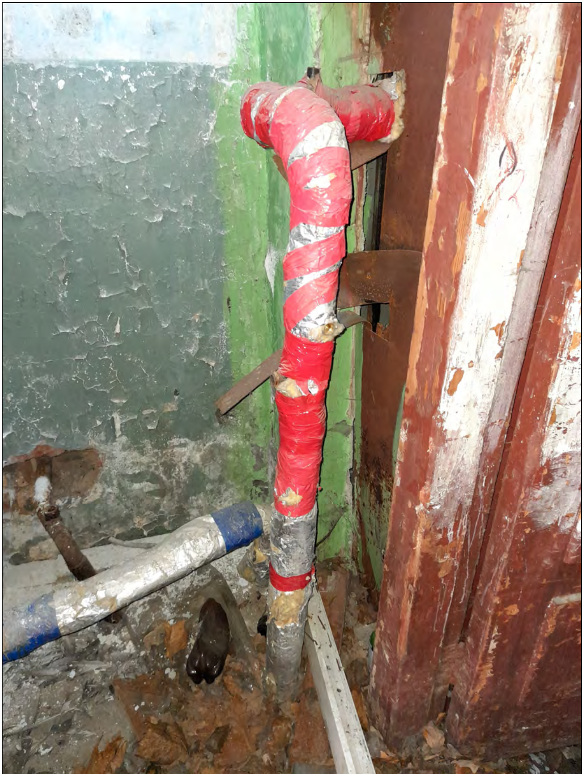
20. Объект культурного наследия «Казарма», в составе комплекса «Казармы 148-го пехотного Каспийского полка (с территорией)», расположенного по адресу: Санкт-Петербург, г. Петергоф, пер. Суворовцев, дом 8, литера А». 1-й этаж. Парадная лестница в осях 5-6. Ввод теплосети в тамбуре . 25.05.2021 г.
