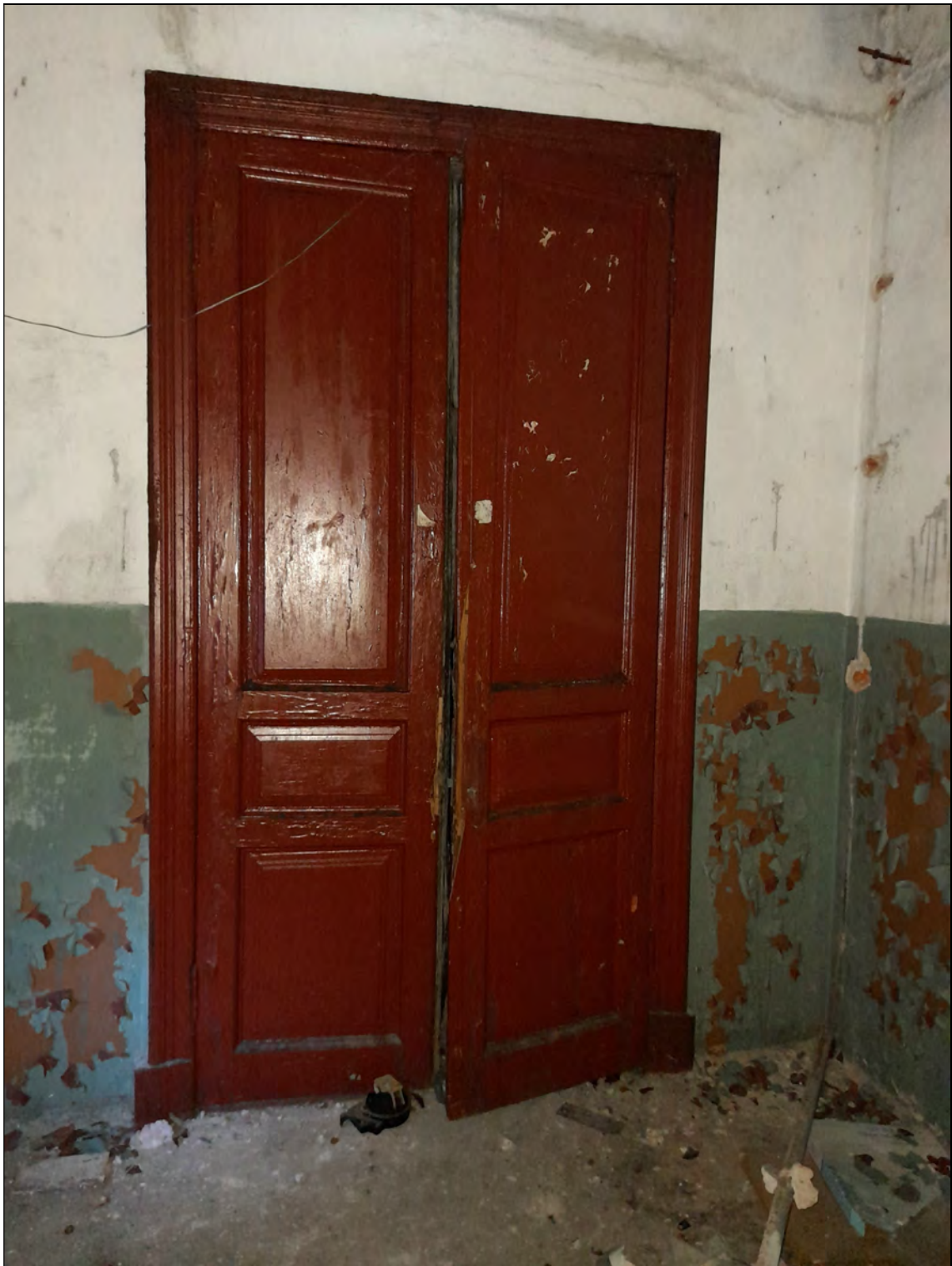
36. Объект культурного наследия «Казарма», в составе комплекса «Казармы 148-го пехотного Каспийского полка (с территорией)», расположенного по адресу: Санкт-Петербург, г. Петергоф, пер. Суворовцев, дом 8, литера А». 2-й этаж. Парадная лестница в осях 5-6. Площадка 2-го этажа. Вход в квартиру № 8. 25.05.2021 г.
