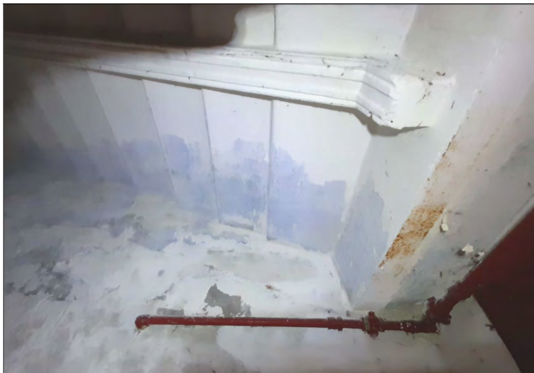
24. Объект культурного наследия «Казарма», в составе комплекса «Казармы 148-го пехотного Каспийского полка (с территорией)», расположенного по адресу: Санкт-Петербург, г. Петергоф, пер. Суворовцев, дом 8, литера А». 1-й этаж. Лестница в осях 1-4/В-Д. Лестничный марш на 2-й этаж. 25.05.2021 г.
