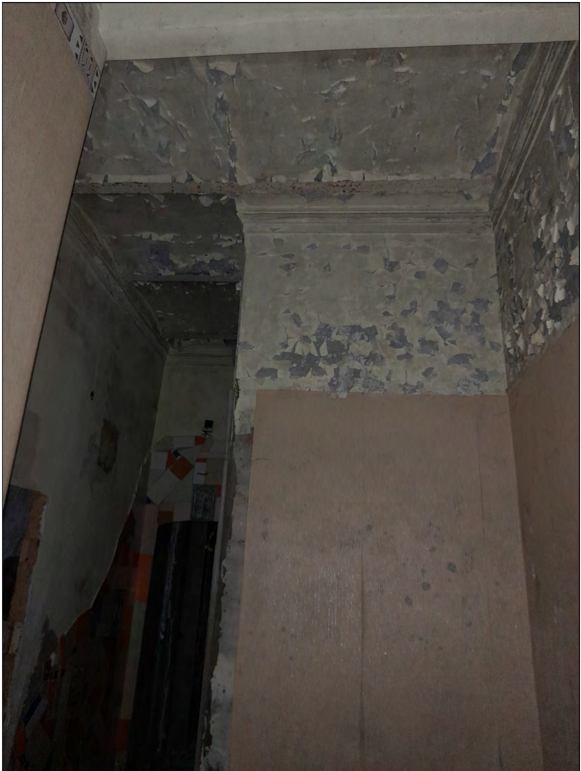
31. Объект культурного наследия «Казарма», в составе комплекса «Казармы 148-го пехотного Каспийского полка (с территорией)», расположенного по адресу: Санкт-Петербург, г. Петергоф, пер. Суворовцев, дом 8, литера А». 1-й этаж. Квартира № 5. Коридор в осях 6-8. 25.05.2021 г.
