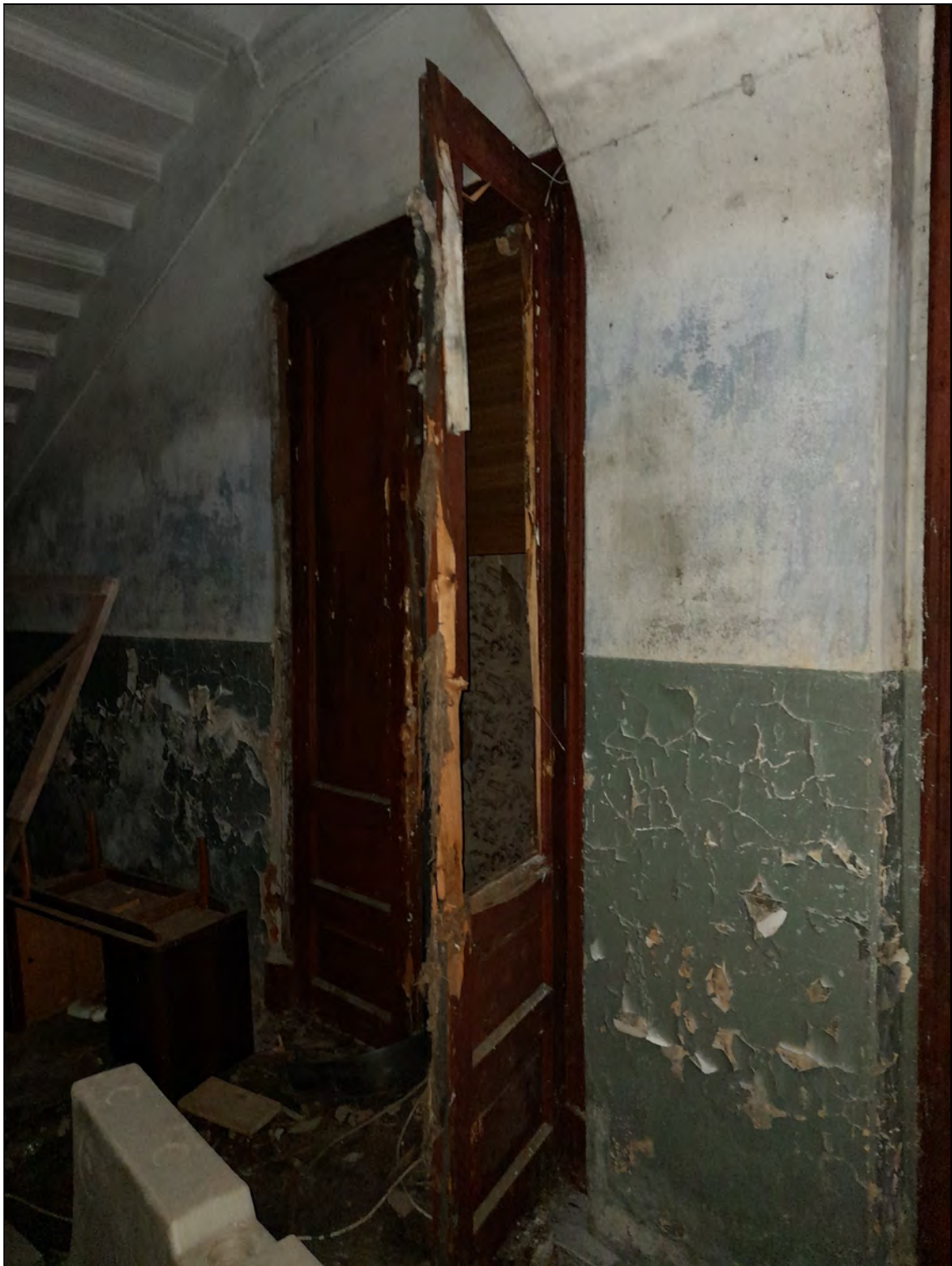
18. Объект культурного наследия «Казарма», в составе комплекса «Казармы 148-го пехотного Каспийского полка (с территорией)», расположенного по адресу: Санкт-Петербург, г. Петергоф, пер. Суворовцев, дом 8, литера А». 1-й этаж. Парадная лестница в осях 5-6. Вход в квартиру № 5. 25.05.2021 г.
