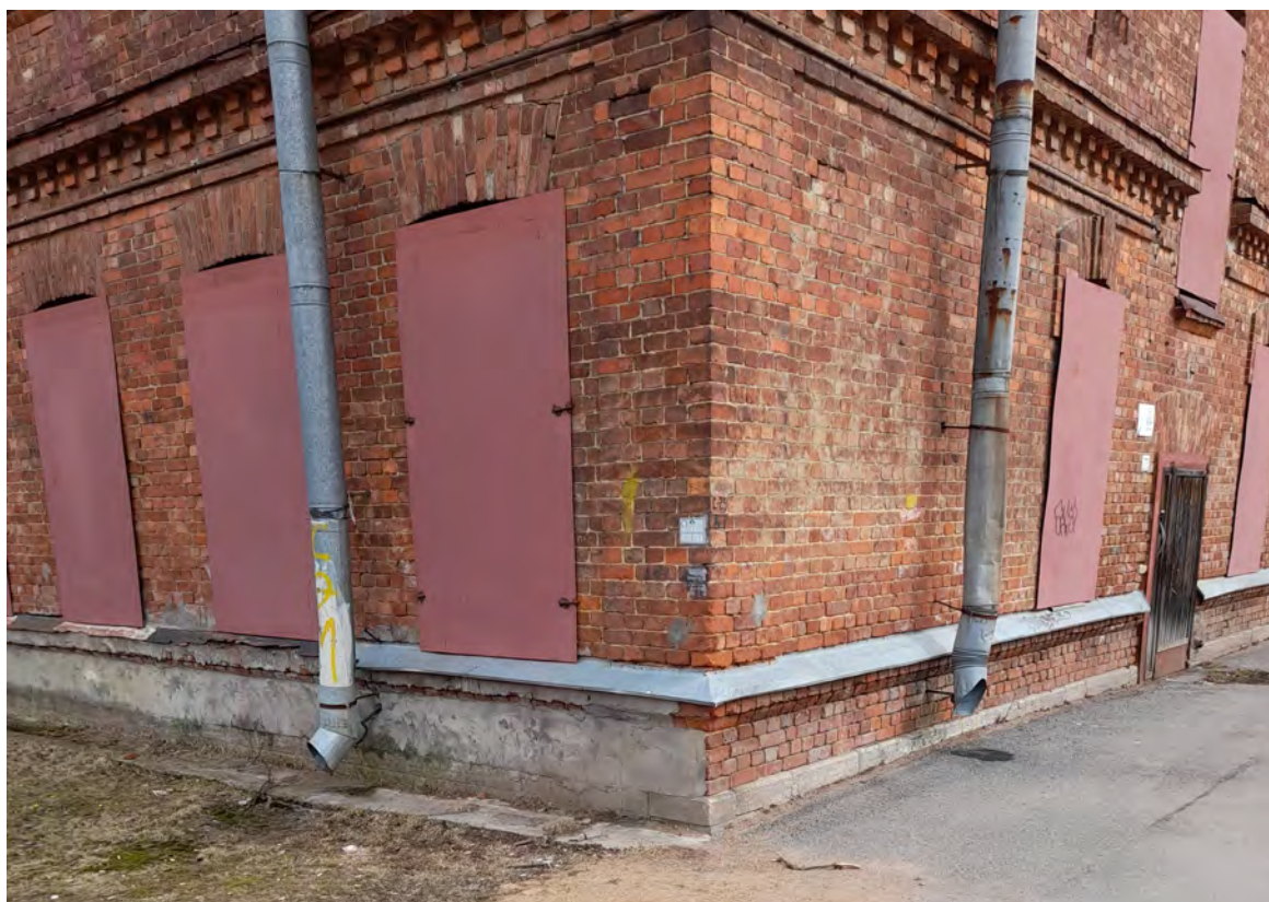
10. Объект культурного наследия «Казарма», в составе комплекса «Казармы 148-го пехотного Каспийского полка (с территорией)», расположенного по адресу: Санкт-Петербург, г. Петергоф, пер. Суворовцев, дом 8, литера А». Южная часть западного фасада. Оконные проемы 1-го этажа. Вид на северо-восток. 25.05.2021 г.
