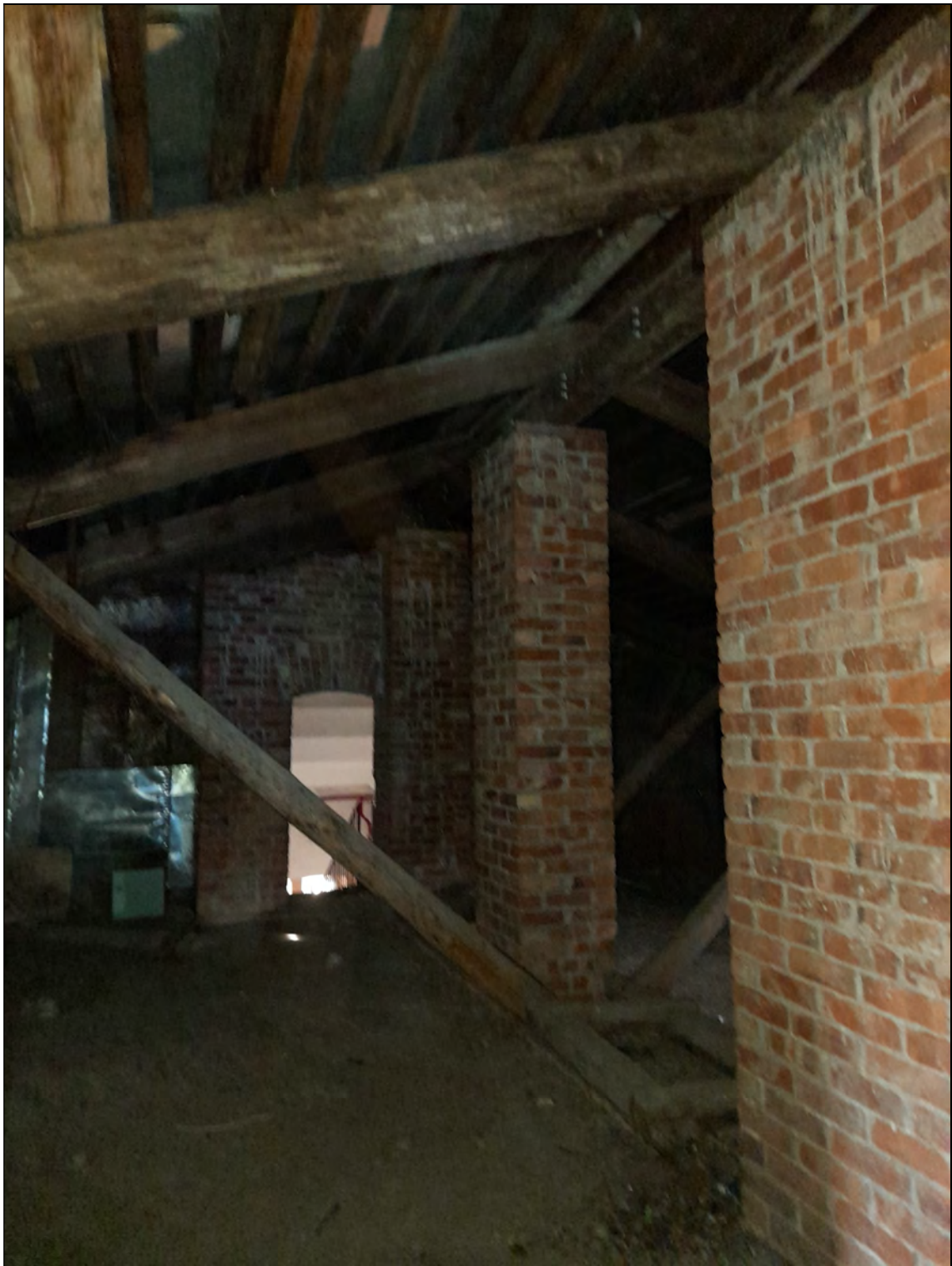
48. Объект культурного наследия «Казарма», в составе комплекса «Казармы 148-го пехотного Каспийского полка (с территорией)», расположенного по адресу: Санкт-Петербург, г. Петергоф, пер. Суворовцев, дом 8, литера А». Чердак. 25.05.2021 г.
