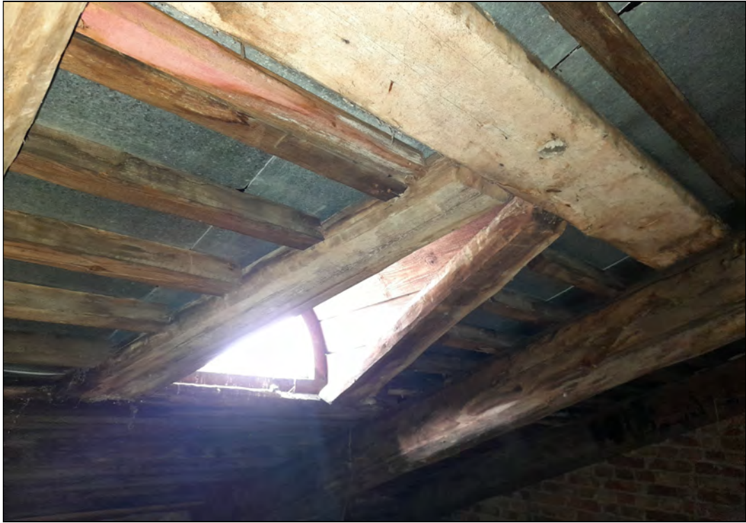
49. Объект культурного наследия «Казарма», в составе комплекса «Казармы 148-го пехотного Каспийского полка (с территорией)», расположенного по адресу: Санкт-Петербург, г. Петергоф, пер. Суворовцев, дом 8, литера А». Чердак. Оконный проем. 25.05.2021 г.
