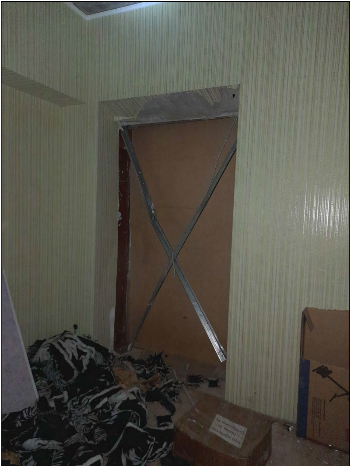
44. Объект культурного наследия «Казарма», в составе комплекса «Казармы 148-го пехотного Каспийского полка (с территорией)», расположенного по адресу: Санкт-Петербург, г. Петергоф, пер. Суворовцев, дом 8, литера А». 2-й этаж. Квартира № 7. Утраченный дверной проем в коридоре в осях 6-7. 25.05.2021 г.
