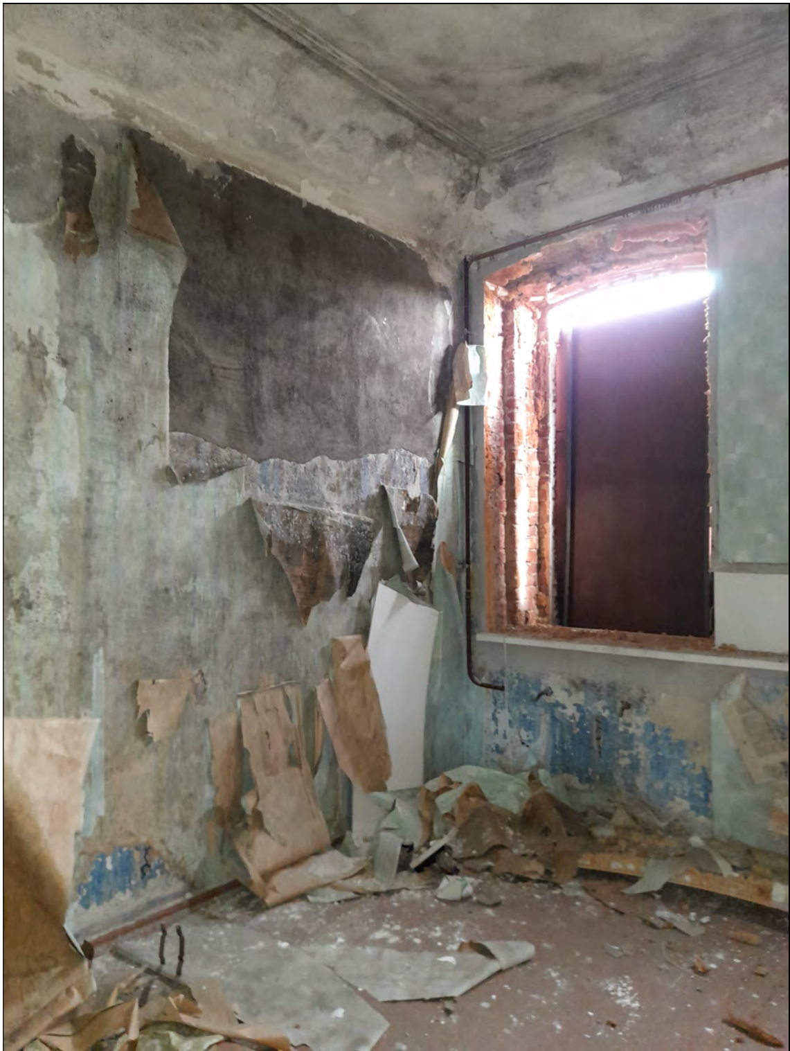
40. Объект культурного наследия «Казарма», в составе комплекса «Казармы 148-го пехотного Каспийского полка (с территорией)», расположенного по адресу: Санкт-Петербург, г. Петергоф, пер. Суворовцев, дом 8, литера А». 2-й этаж. Квартира № 3. Комната в осях 4-5. 25.05.2021 г.
