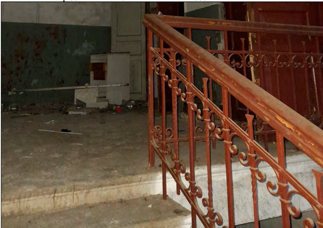
35. Объект культурного наследия «Казарма», в составе комплекса «Казармы 148-го пехотного Каспийского полка (с территорией)», расположенного по адресу: Санкт-Петербург, г. Петергоф, пер. Суворовцев, дом 8, литера А». 2-й этаж. Парадная лестница в осях 5-6. Площадка 2-го этажа. Ограждение лестницы. 25.05.2021 г.
