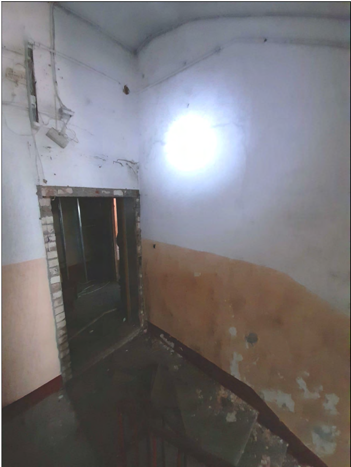
39. Объект культурного наследия «Казарма», в составе комплекса «Казармы 148-го пехотного Каспийского полка (с территорией)», расположенного по адресу: Санкт-Петербург, г. Петергоф, пер. Суворовцев, дом 8, литера А». 1-й этаж. Лестница в осях 7-10/В-Д. Площадка 1-го этажа. Вход в квартиру № 7. 25.05.2021 г.
