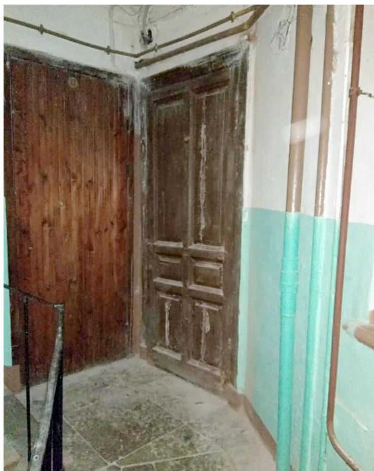
Фото 15. «Черная» лестница входа со двора. Лестничная площадка 1-го этажа. Справа – дверь в кв. №10.
