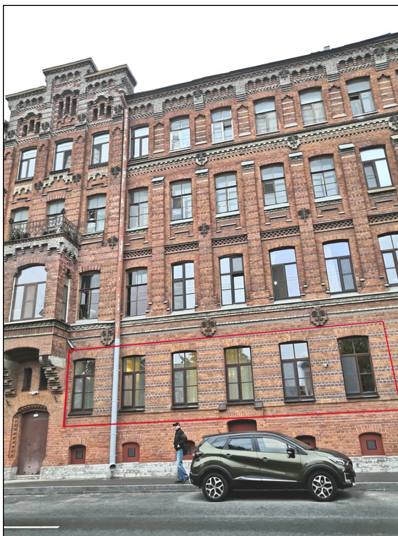
Фото 5. Фрагмент лицевого (южного) фасада по наб. р. Фонтанки. Справа – обозначены окна квартиры №10. Вид с юга.
