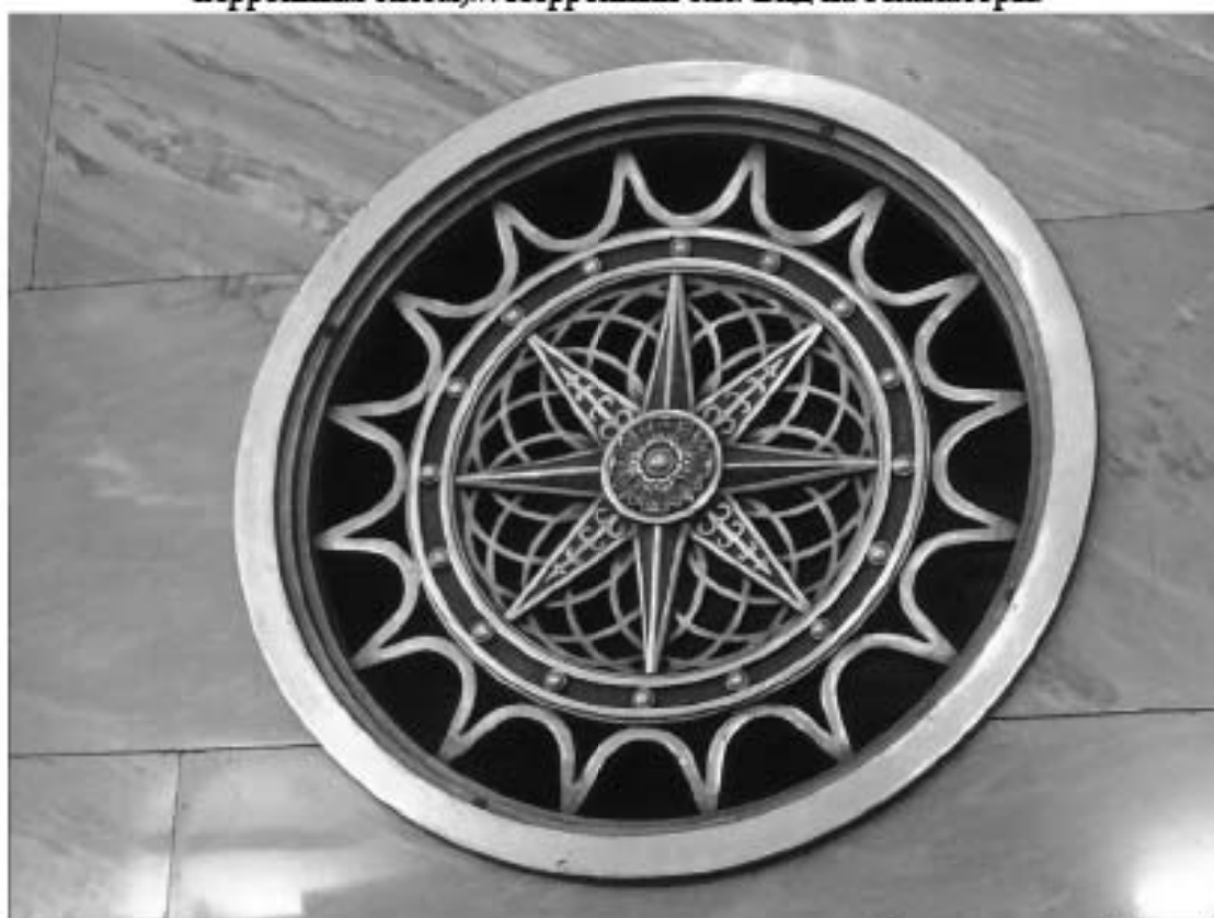
Фото 8. Объект культурного наследия регионального значения «Станция метро «Балтийская» (с перронным залом)». Перронный зал. Вид вентиляционной решетки.
