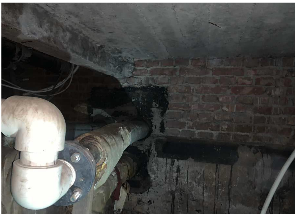
Фото 22. Объект культурного наследия регионального значения «Жилой дом специалистов «Свирьстроя», Санкт-Петербург, Малый проспект П.С., 84-86, лит.А. Помещение б/н16 (1). Ввод инженерных сетей в здание.
