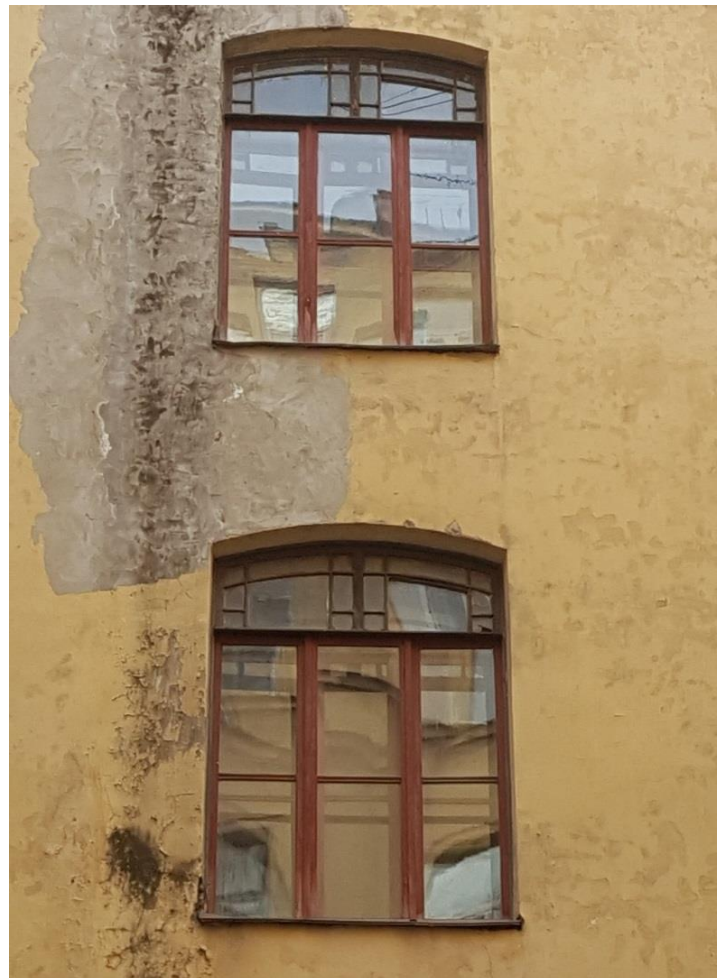
Фото 19. Расстекловка окон в уровне 3 и 4-го этажей.
