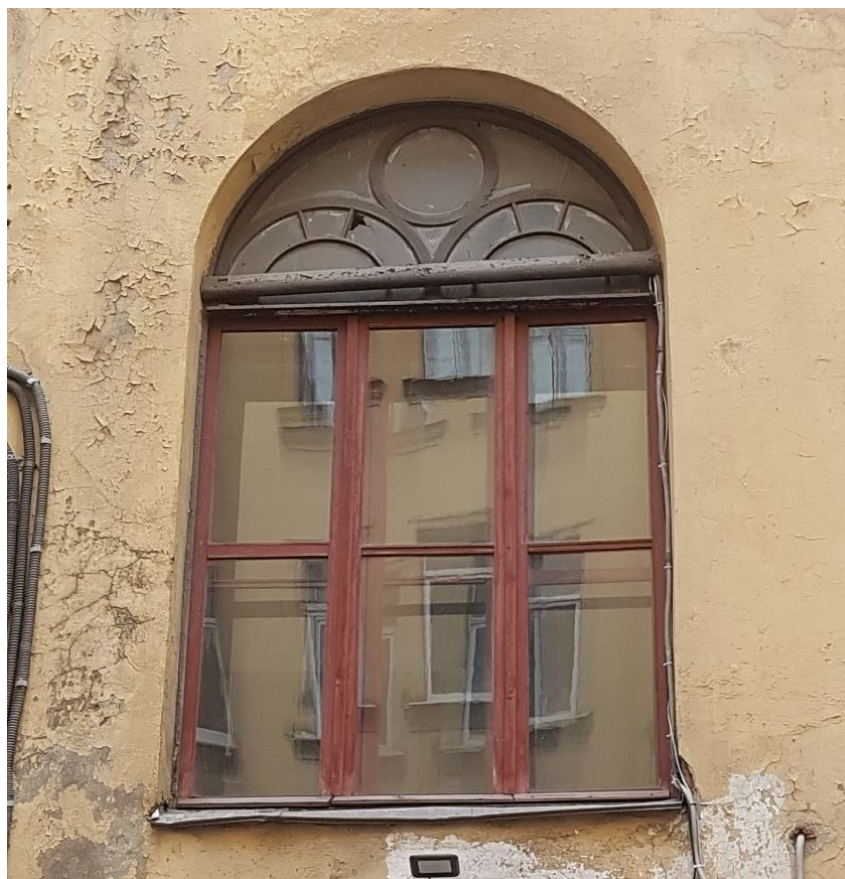
Фото 20. Расстекловка окон в уровне 2-го этажа.
