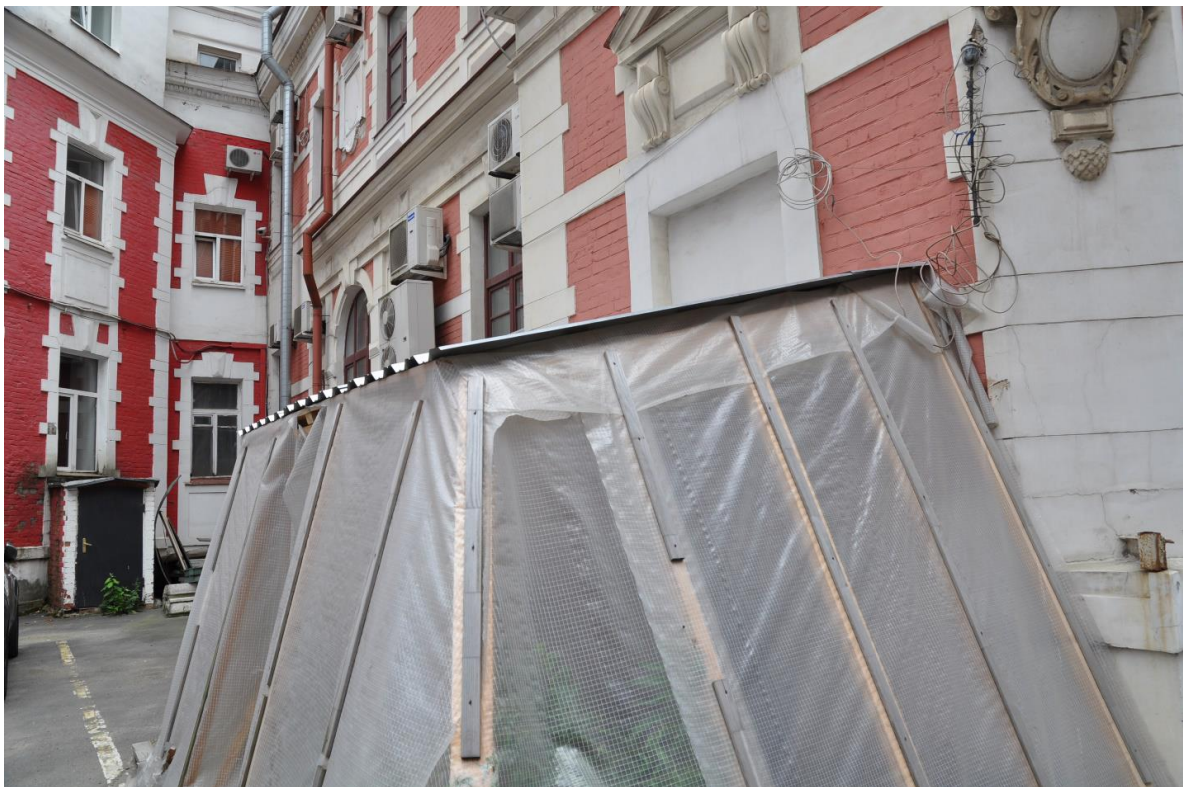
2. Фрагмент северного дворового фасада. Прямо́к закрыт временным навесом
