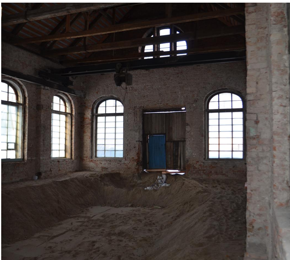
Фото 11. Выявленный ОКН «Павловская электрическая станция (с 2 службами и оградой)». Главное здание. Машинный зал. Общий вид. Съёмка 15.03.2022 г.
