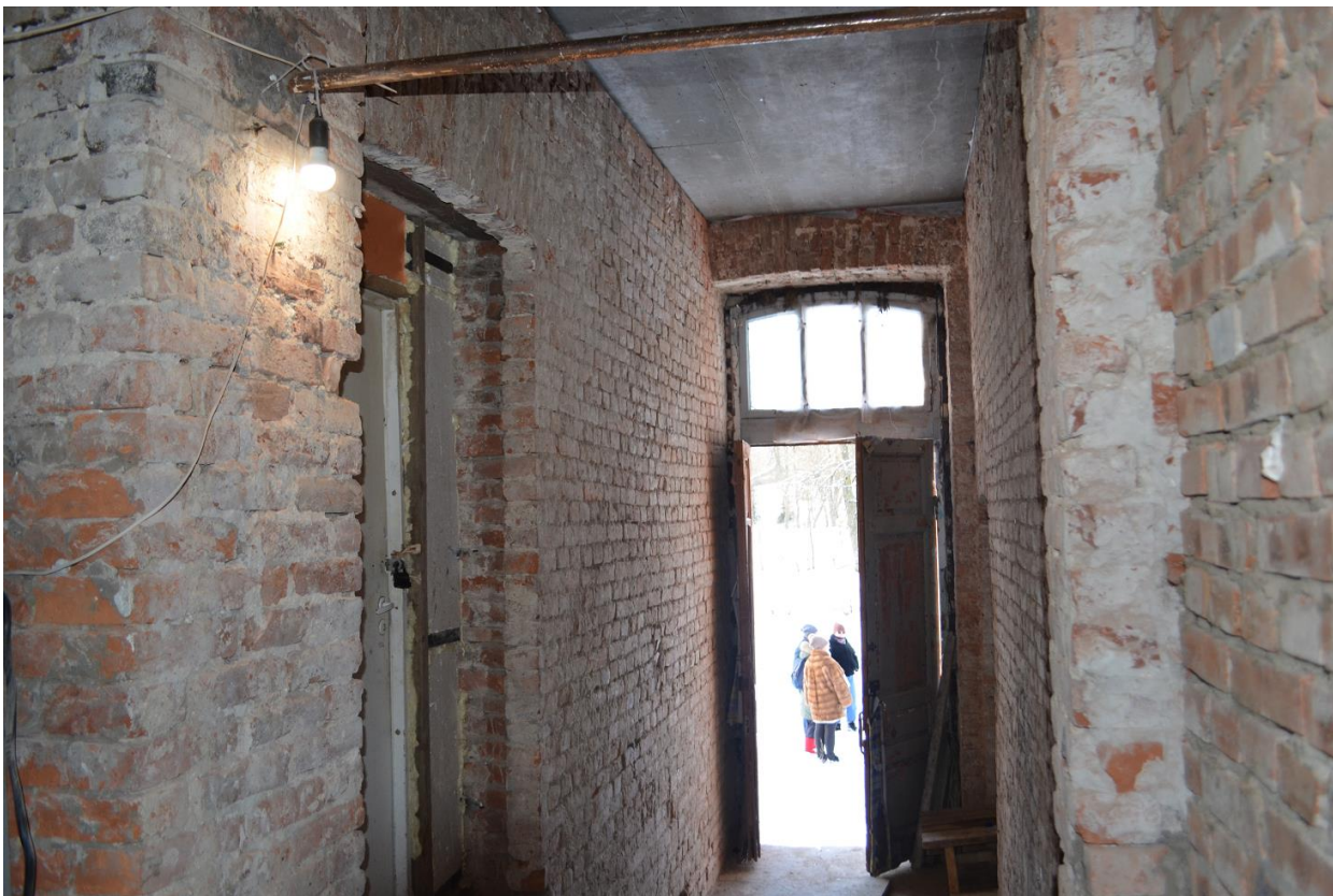
Фото 15. Выявленный ОКН «Павловская электрическая станция (с 2 службами и оградой)». Главное здание. Помещение 1-Н (8). Съёмка 15.03.2022 г.
