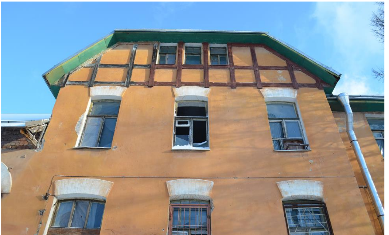
Фото 09. Выявленный ОКН «Павловская электрическая станция (с 2 службами и оградой)». Главное здание. Юго-западный фасад. Фрагмент. Съёмка 15.03.2022 г.
