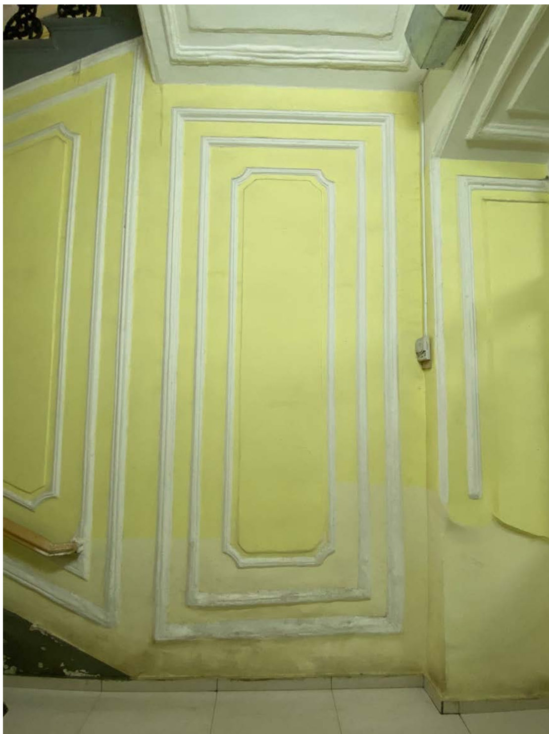
23. Объект культурного наследия «Комплекс зданий Дома призрения А.И. Тименкова и В.А. Фролова». Помещение №3. Вид на запад. 18.06.2021 г.
