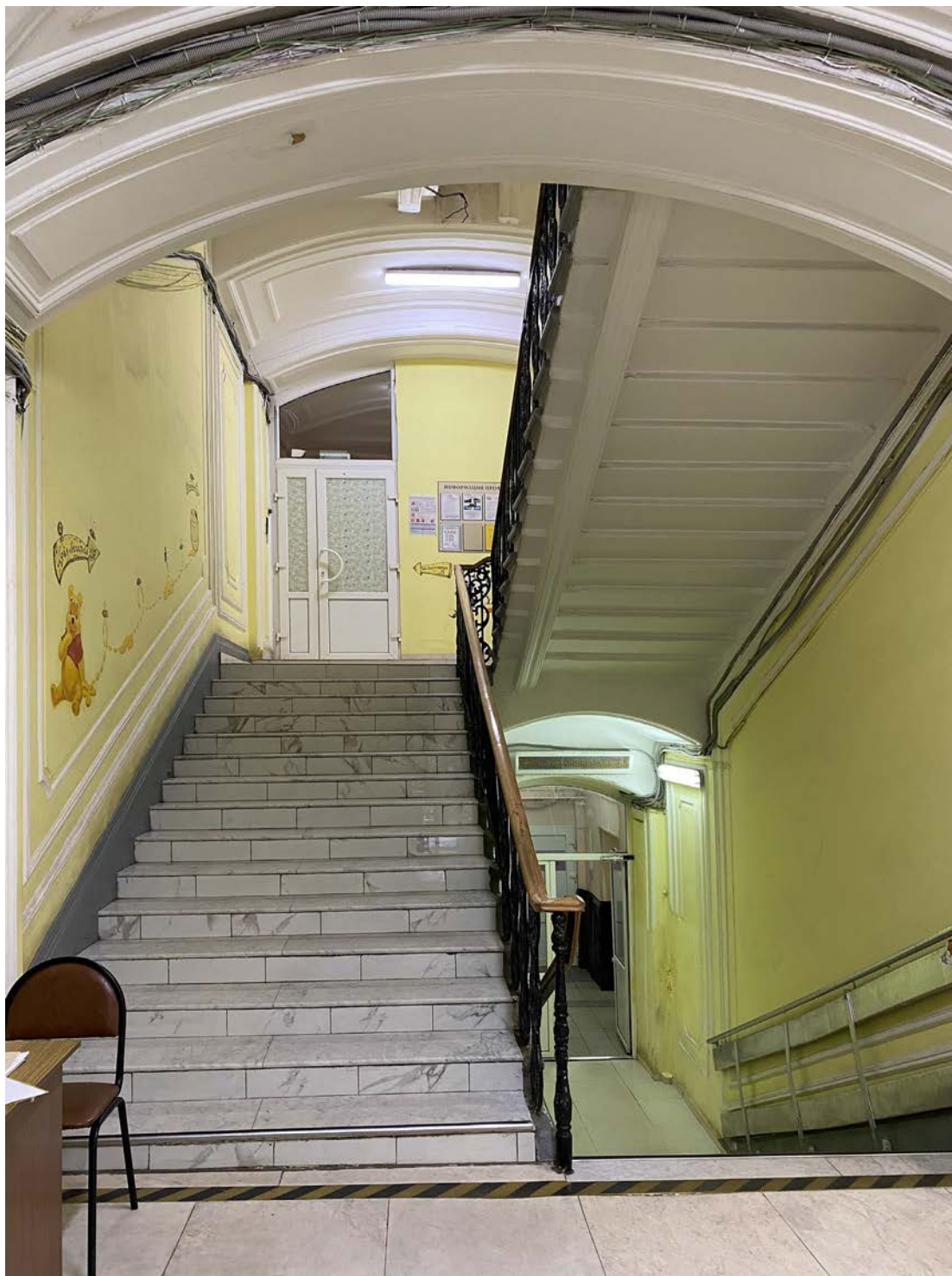
24. Объект культурного наследия «Комплекс зданий Дома призрения А.И. Тименкова и В.А. Фролова». Помещение №3. Вид на север. 18.06.2021 г.
