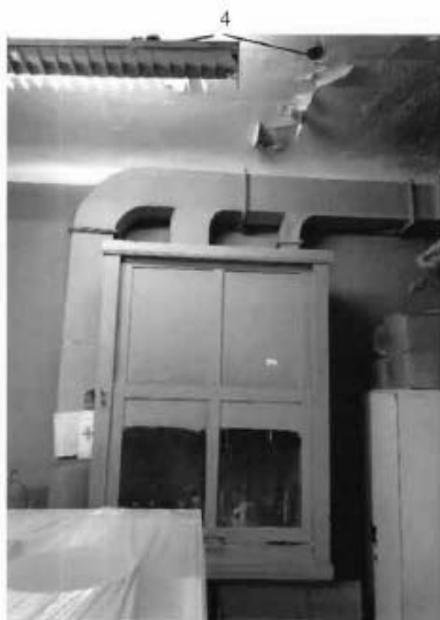
6. Вытяжной шкаф в здании 2-го корпуса
