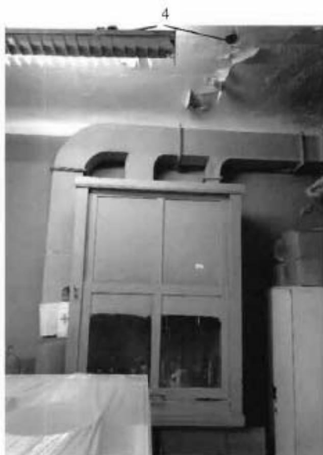
6. Вытяжной шкаф в здании 2-го корпуса
