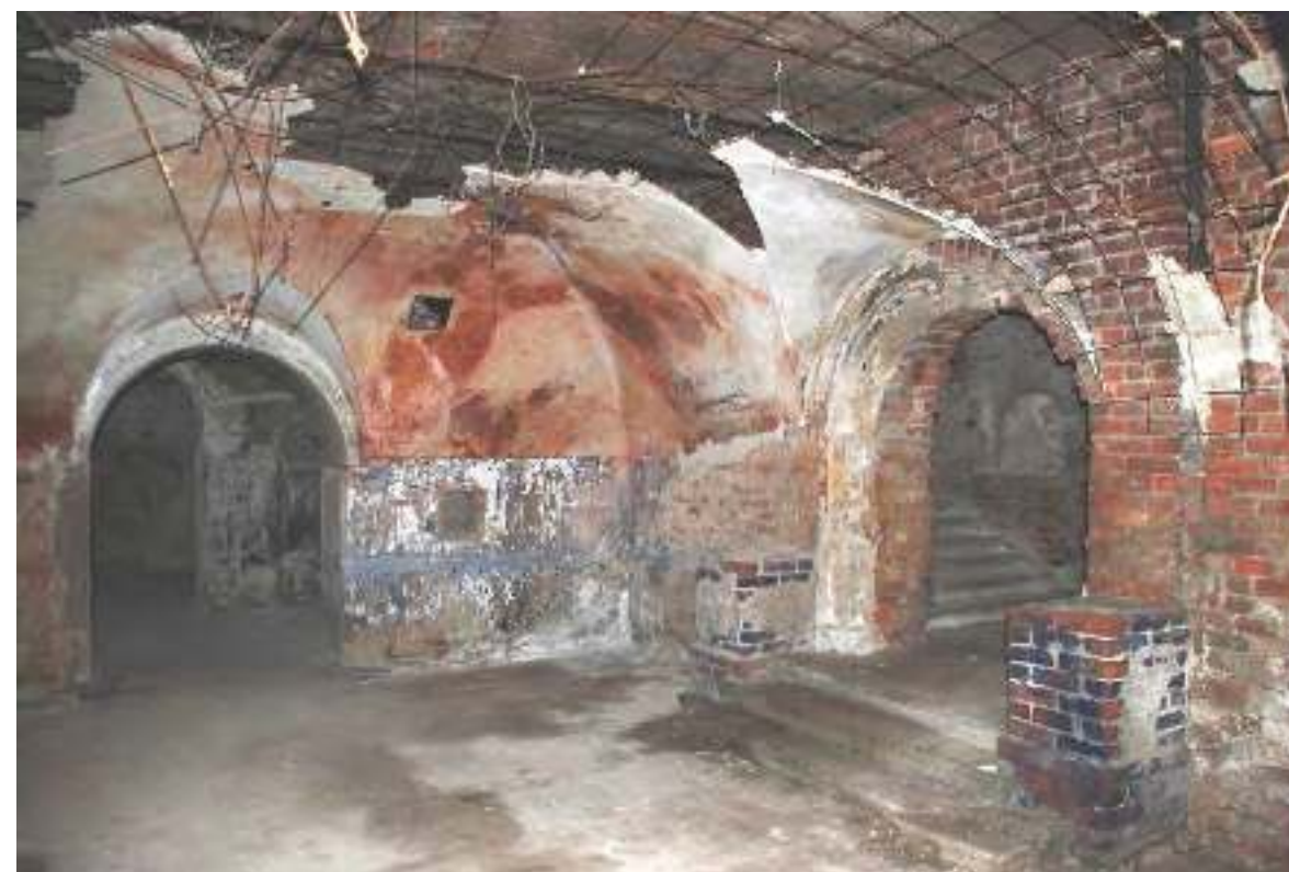
Илл. 106. Теплые сени. Общий вид. Фото 2008 г. Видны металлические конструкции ложных сводов.
