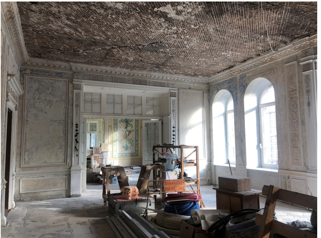
25. Выявленный объект культурного наследия «Дом М.М.Верховского» (г. Санкт-Петербург, Кировская ул., д. 22, лит. А). Помещение кв. №2.
