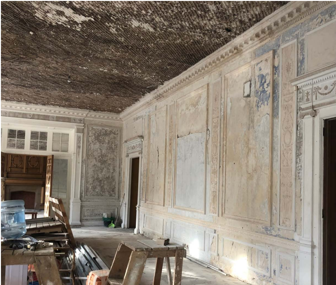
26. Выявленный объект культурного наследия «Дом М.М.Верховского» (г. Санкт-Петербург, Кирочная ул., д. 22, лит. А). Помещение кв. №2.
