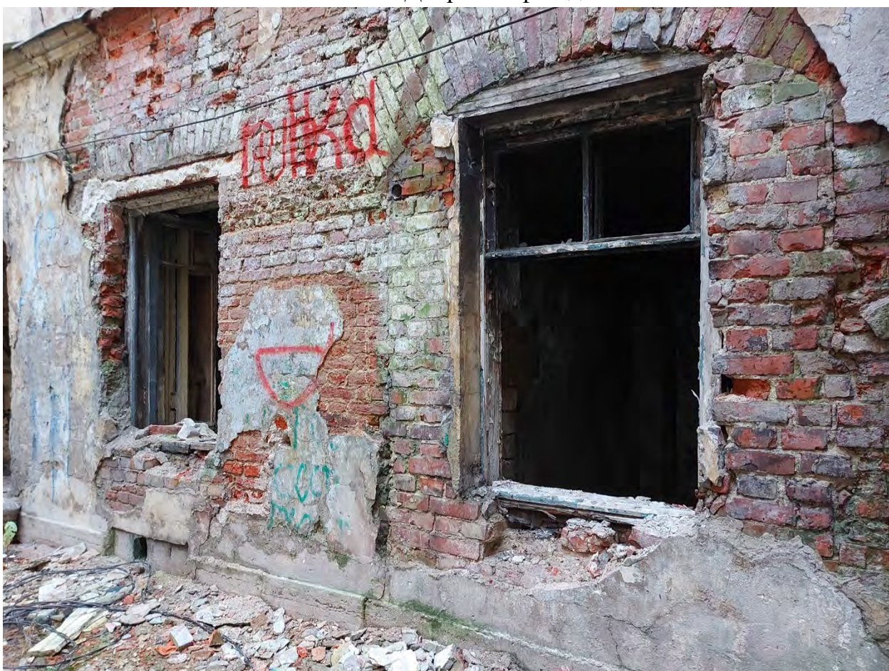
Фото 11. Проемы первого этажа.
