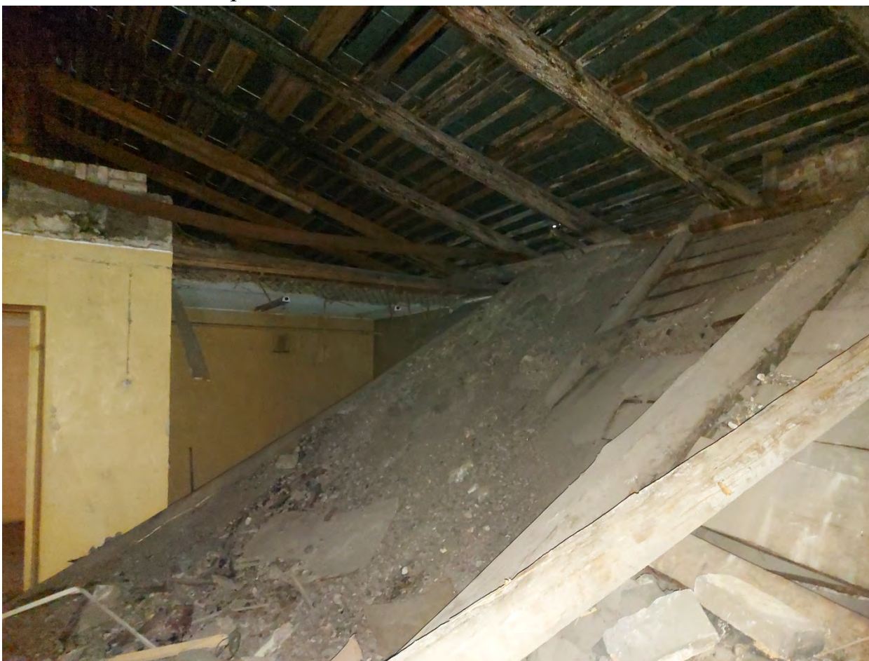
Фото 61. Обрушение перекрытия третьего этажа в пом.7.
