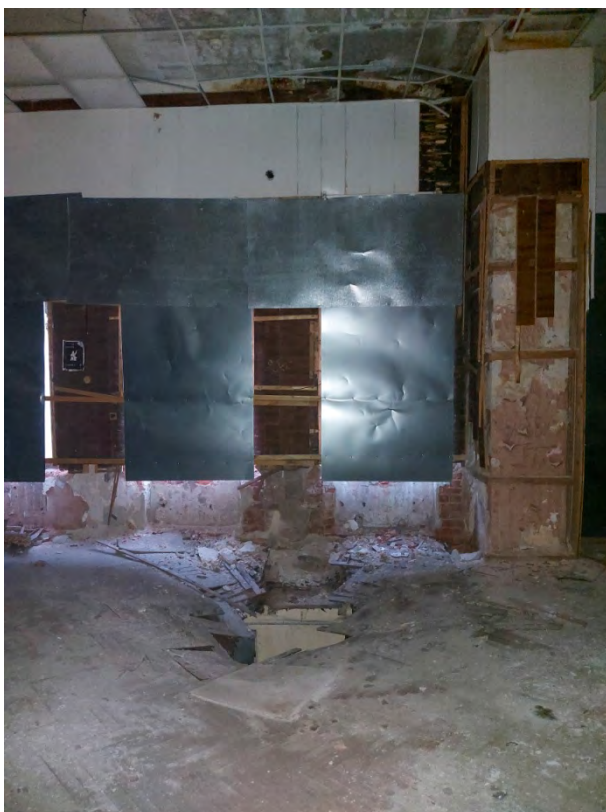
Фото 44. Помещение 14, разрушение перекрытия.
