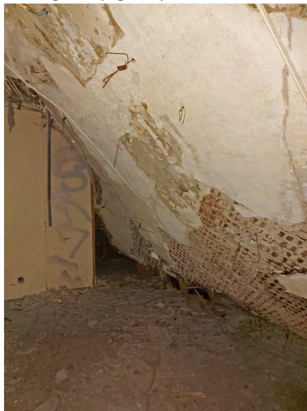
Фото 21. Помещение 20, обрушение перекрытия.
