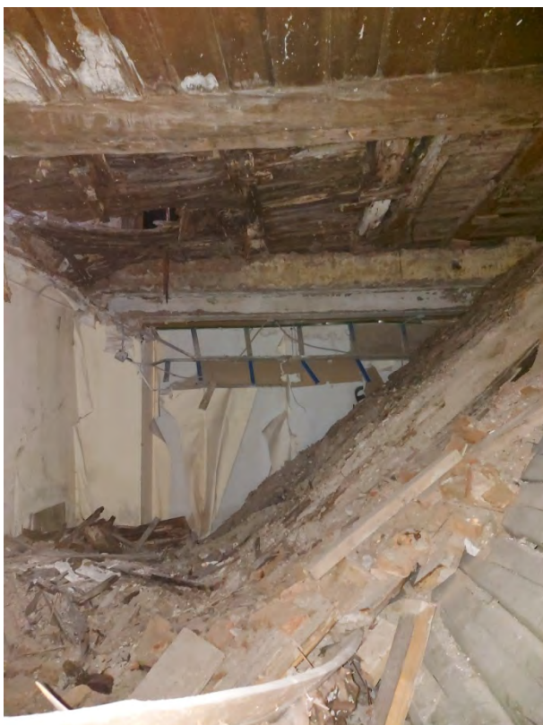
Фото 34. Помещение 20, разрушение перекрытия.
