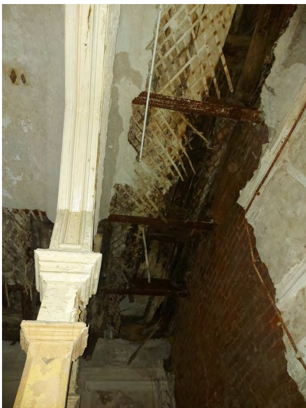
Фото 38. Разрушение перекрытия в парадной лестнице.
