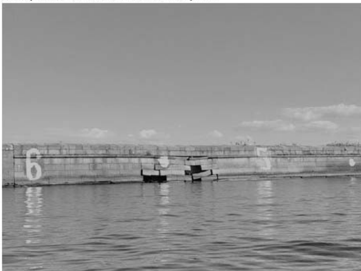
Рис. 232. Кронштадт. Каботажная гавань. Восточный причал. Просадки и обвал гранитных блоков облицовочной стенки.
