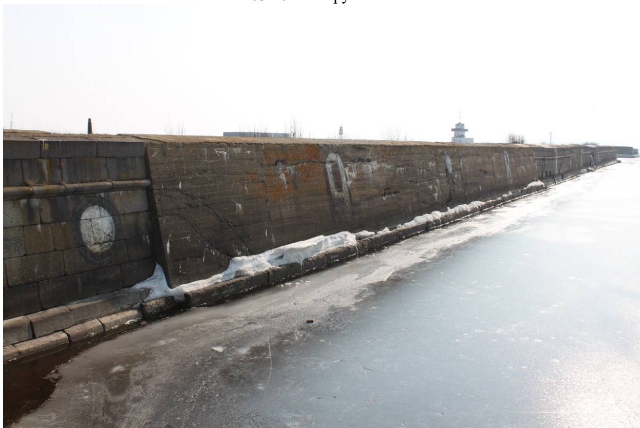
Илл. 06. Объект культурного наследия федерального значения «Гидротехнические сооружения». Южная часть западного оградительного мола. Стенка со стороны Каботажной гавани. Съемка 22.03.2022 г. Трушковский В.Э.
