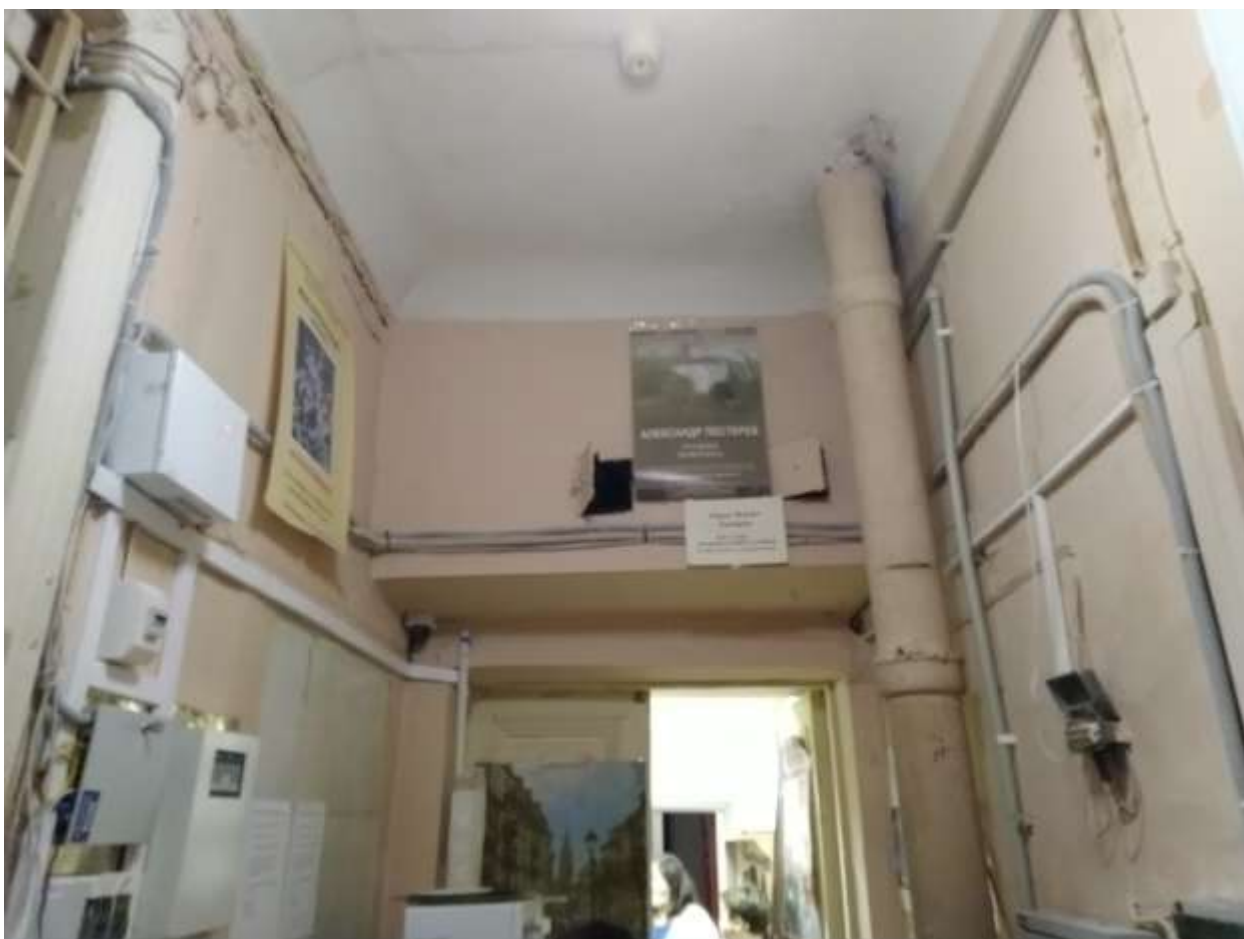
20. Коридор. Существующие инженерные сети.
