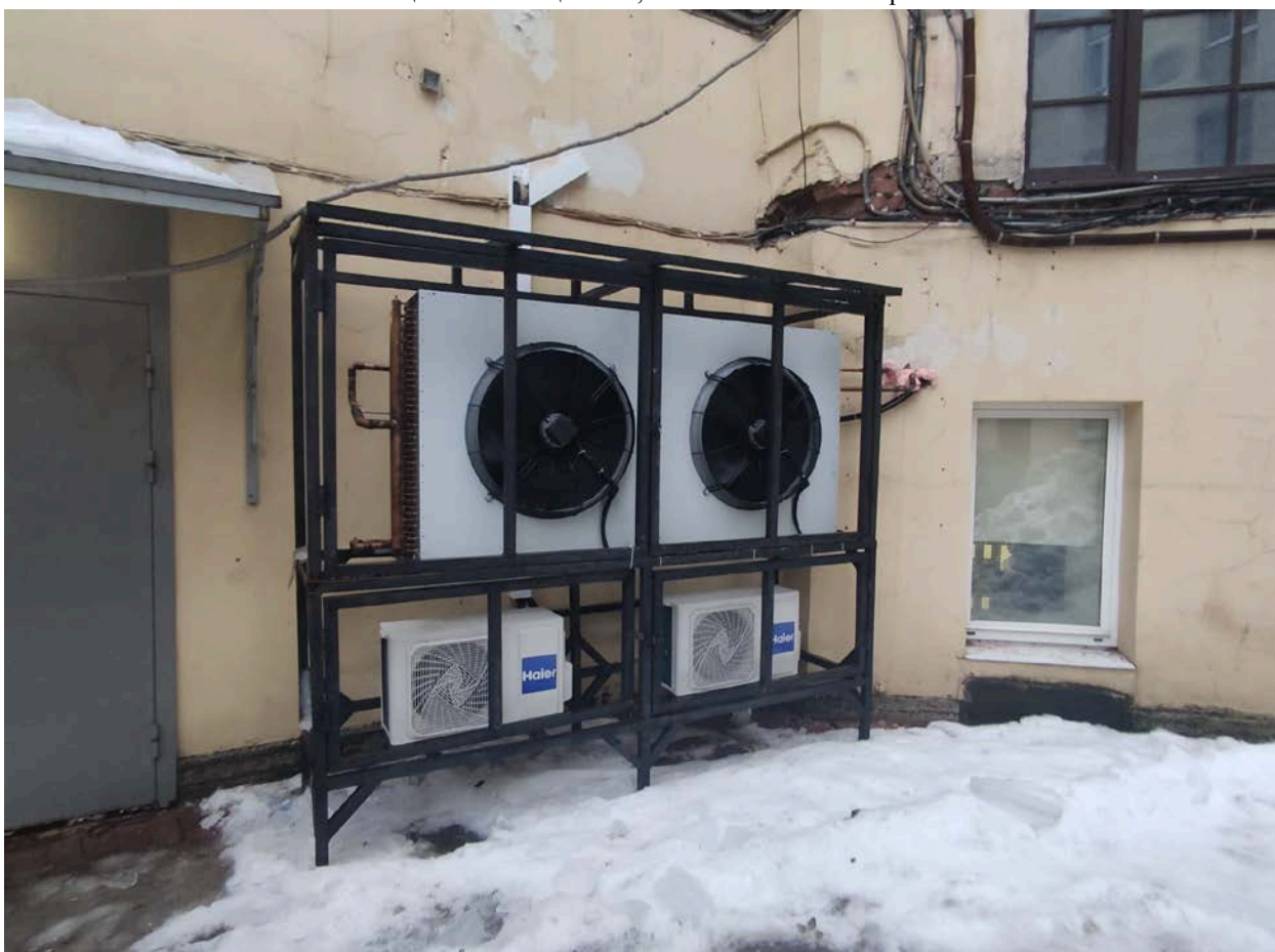
Фото 12. Фрагмент дворового фасада объекта культурного наследия «Дом Санкт-Петербургского Мещанского общества», наружные блоки систем кондиционирования
